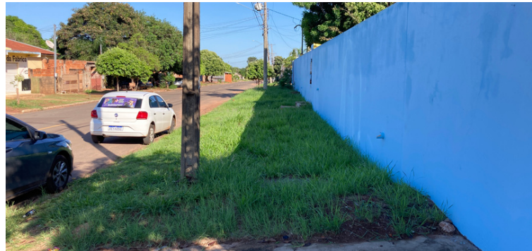
Foto 6 Calçada na lateral da escola sem pavimentação, com necessidade de manutenção na área verde.
