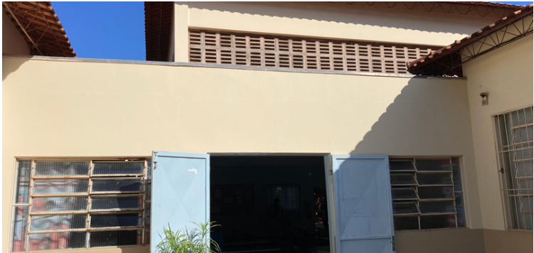
Foto 3 Local em que a placa de identificação da Escola caiu.
