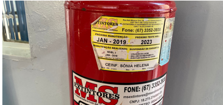
Foto 4 Extintor de incêndio com prazo de validade vencido desde janeiro de 2019.
