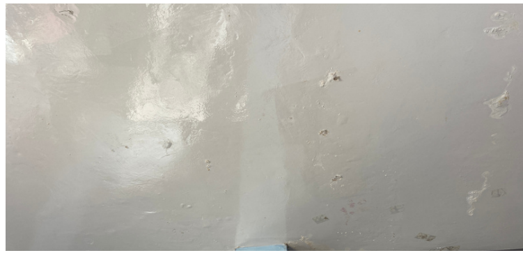
Foto 2 Infiltrações na estrutura próximo a porta de entrada do refeitório.
