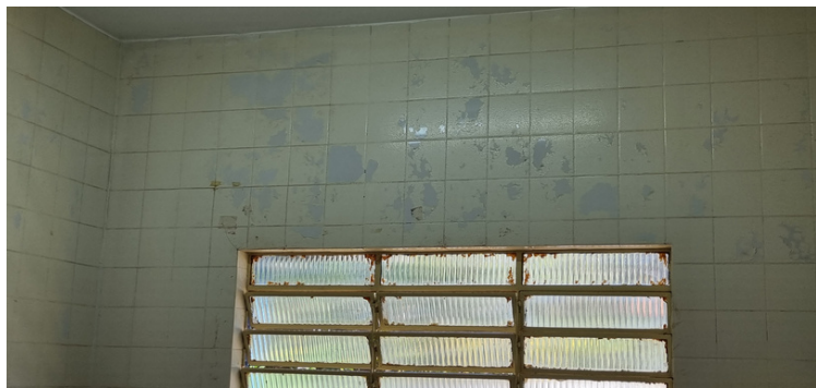
Foto 3 - Consultório com a pintura desgastada
