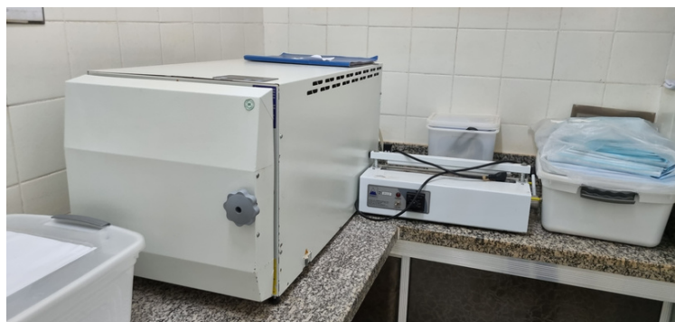
Foto 6 - Autoclave em desuso devido à falta de manutenção
