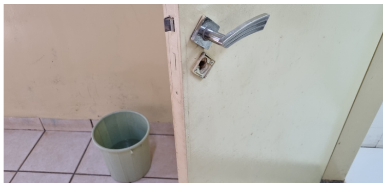
Foto 8 - Banheiro com a trinca avariada
