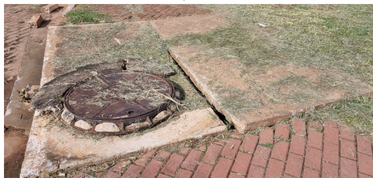
Foto 8 Desnível na pista de caminhada
