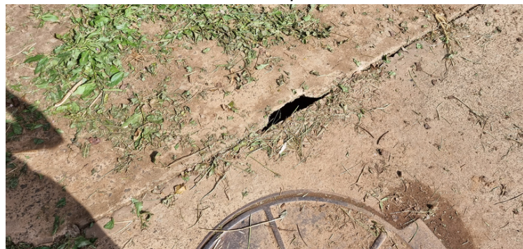
Foto 6 Buraco na pista de caminhada
