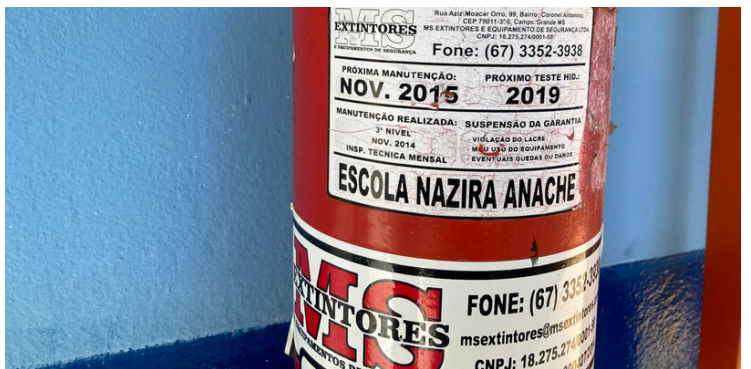
Foto 6 - Extintores com as datas de validade expiradas
