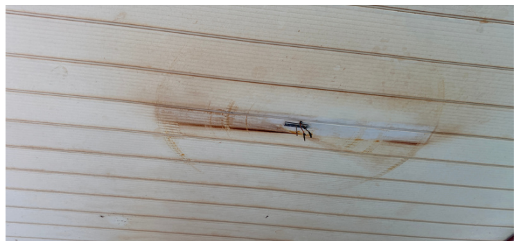
Foto 8 - Parte elétrica ausente de manutenção
