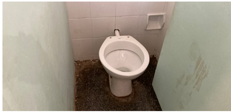
Foto 2 - Banheiros higienizados, porém sem a devida manutenção
