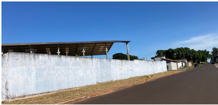
Foto 4 - Iluminação pública ausente na parte posterior da escola
