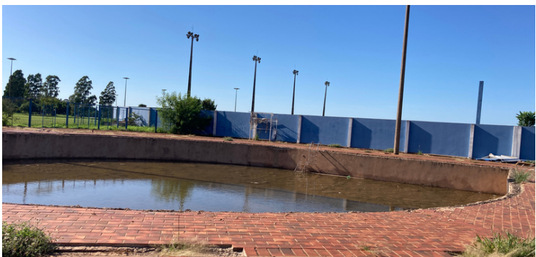
Foto 3 - Obras das piscinas não finalizadas, visto que a empreiteira responsável abandonou sua execução
