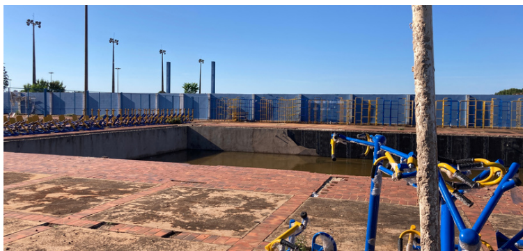
Foto 4 - Piscina abandonada gerando acúmulo de água pluvial
