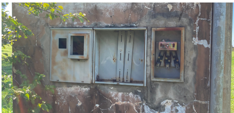
Foto 9 - Padrão de luz cuja a fiação fora subtraída
