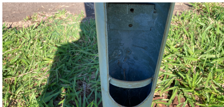
Foto 8 - Poste cuja fiação elétrica fora objetivo de furto
