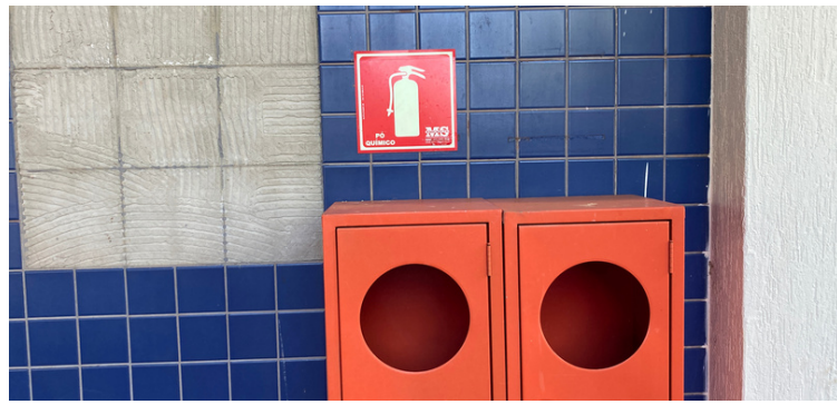
Foto 2 - Caixas de incêndio desguarnecidas de extintores
