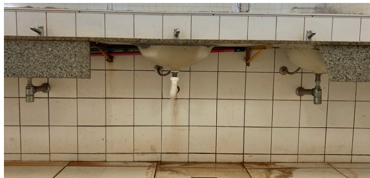
Foto 6 - Vazamento na tubulação hídrica e avaria na bancada do banheiro feminino
