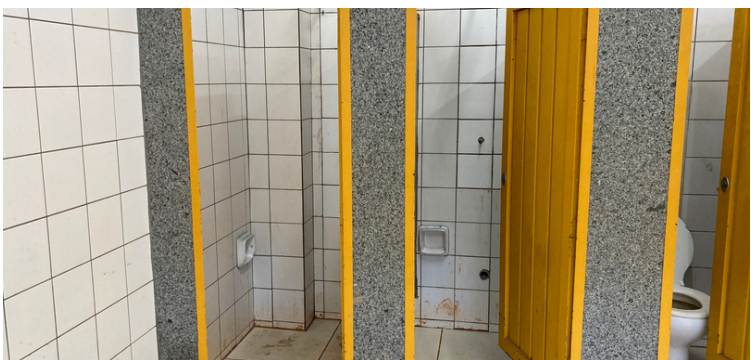
Foto 7 - Banheiros sem a devida manutenção e higienização
