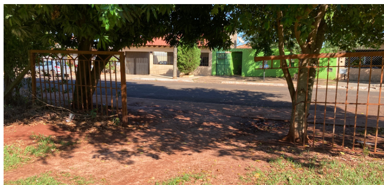
Foto 9 - Parte da estrutura da cerca avariada
