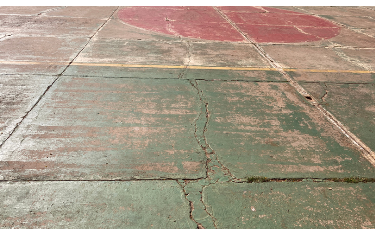
Foto 3 - Rachaduras constantes no piso da quadra de esportes
