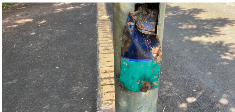
Foto 17 Proteção para evitar furto da fiação
