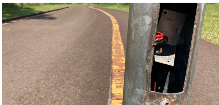
Foto 19 Furto de fiação
