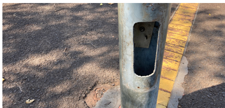
Foto 16 Passagem de fios são furtados
