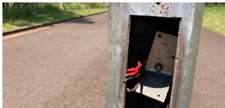
Foto 18 Fios expostos por conta de furtos
