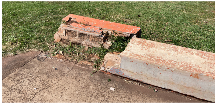
Foto 1 Bancos quebrados no centro da Praça do Papa.
