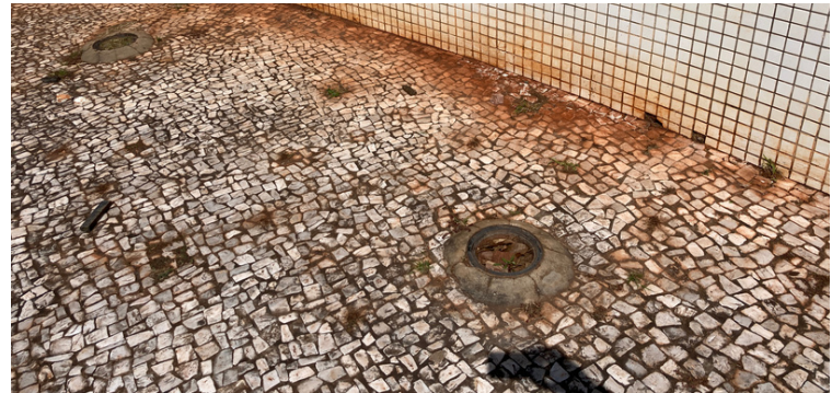
Foto 6 Luminárias danificadas na galeria dos Papas.
