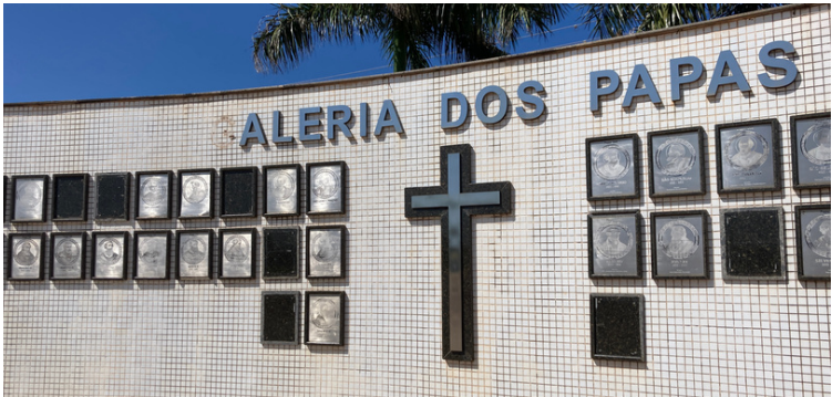
Foto 5 Galeria depredada, faltando quadros e letras no nome.
