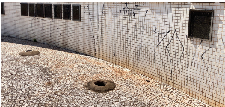
Foto 7 Pontos de iluminação sem lâmpadas.
