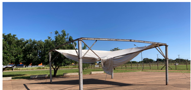
Foto 8 Tenda no centro da praça danificada, podendo acumular água.
