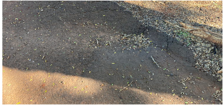
Foto 4 Desnível na pista de caminhada causado por raízes de árvores.
