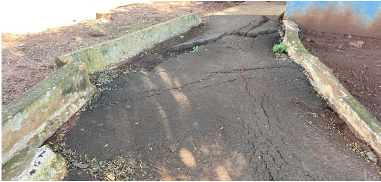
Foto 3 Pista de caminhada desnivelada, com rachaduras e buracos.
