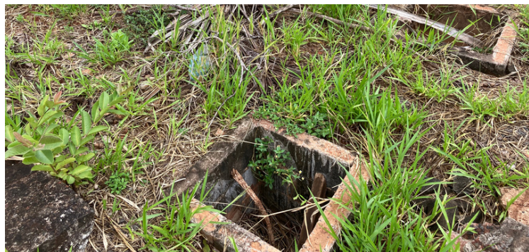
Foto 5 Caixas de esgoto sem tampa
