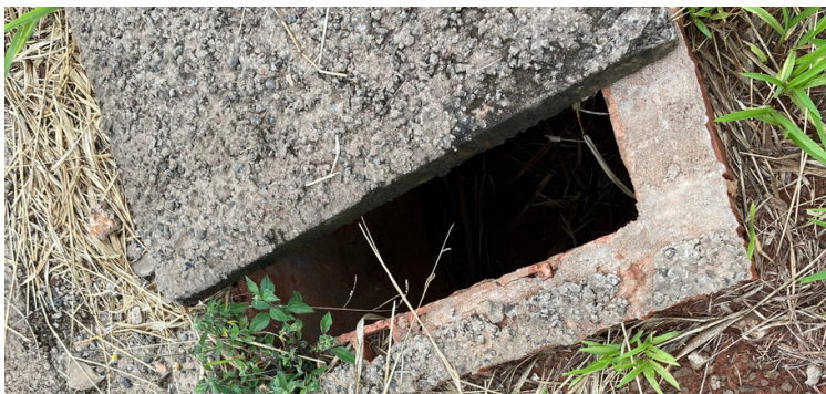
Foto 4 Tampas de esgoto aberta
