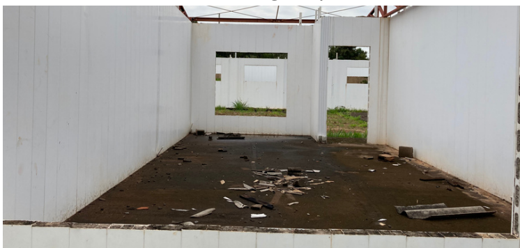
Foto 8 Acúmulo de lixo
