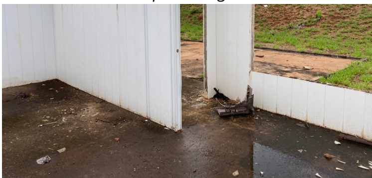
Foto 6 Acúmulo de água quando chove
