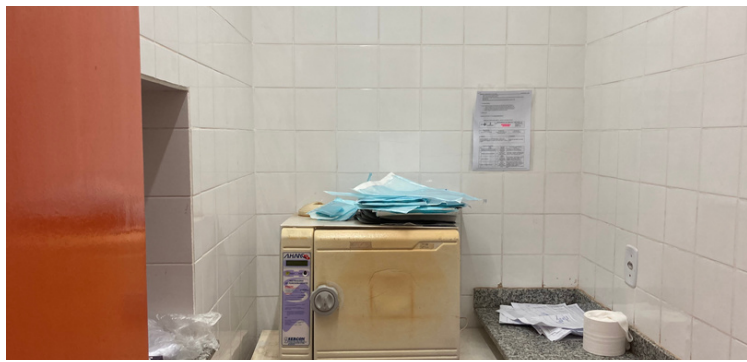
Foto 11 Autoclave com defeito
