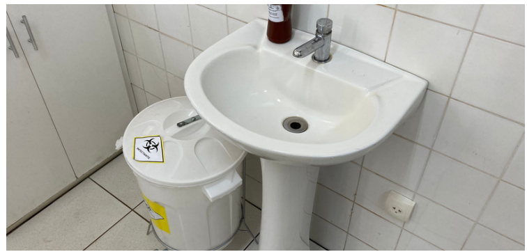
Foto 12 Pia com vazamento
