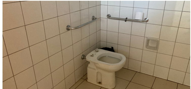
Foto 18 Vaso sanitário sem assento
