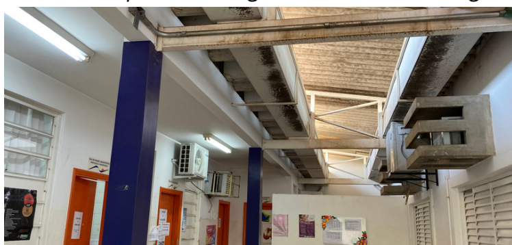
Foto 7 Recepção sem extintores
