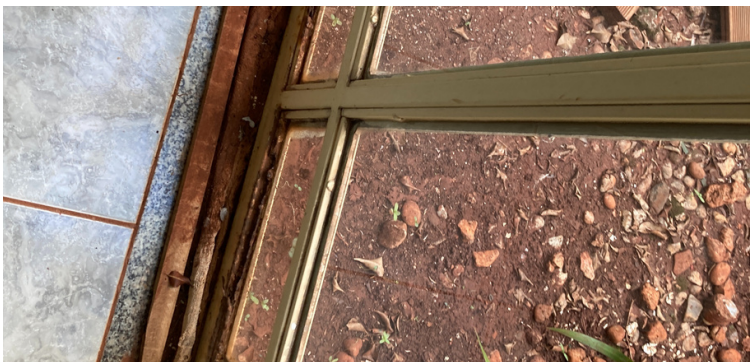
Foto 5 Ferrugem na porta que dá acesso ao jardim de inverno ao lado da sala da gerência.
