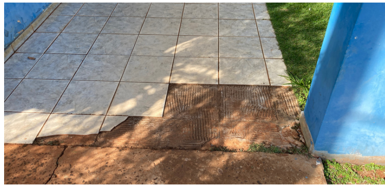
Foto 2 Piso danificado no acesso à unidade de saúde.
