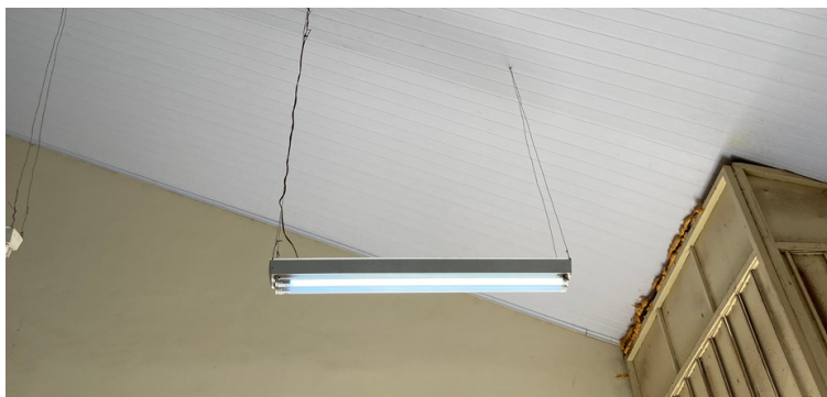
Foto 4 Luminárias da recepção penduradas apenas pela fiação.
