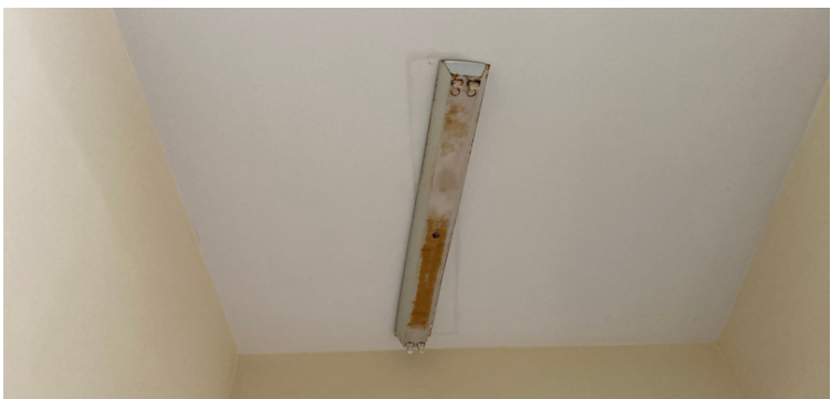
Foto 3 Falta de lâmpadas na luminária localizada no corredor de acesso aos consultórios.
