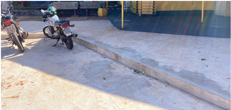
Foto 13 Parte da obra iniciada em 2021, porém foi paralisada.
