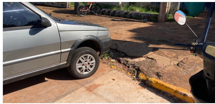
Foto 2 Falta de acessibilidade na entrada da UBS.
