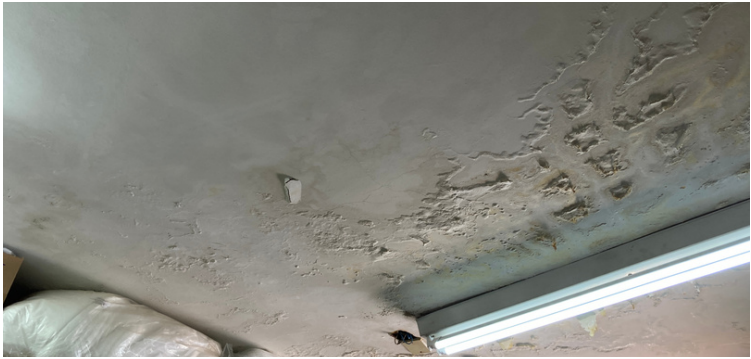
Foto 11 Infiltração com presença de fungos no teto da farmácia.
