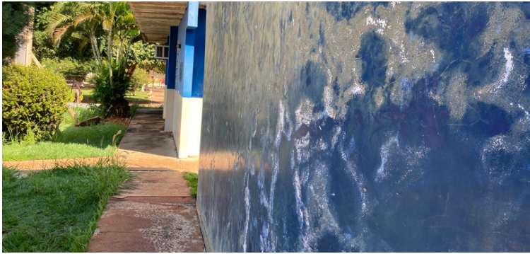
Foto 3 Pintura da área externa em situação deplorável.
