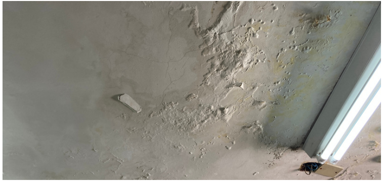
Foto 12 Infiltração no teto da farmácia.
