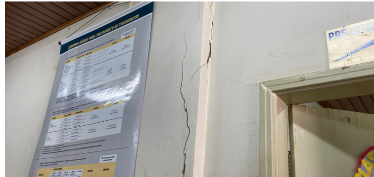
Foto 6 Rachadura na parede da recepção próximo a sala de curativo.
