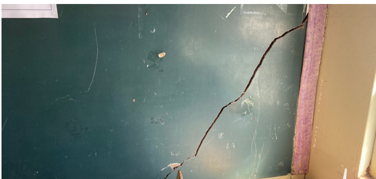
Foto 7 Rachadura na sala dos agentes comunitários.
