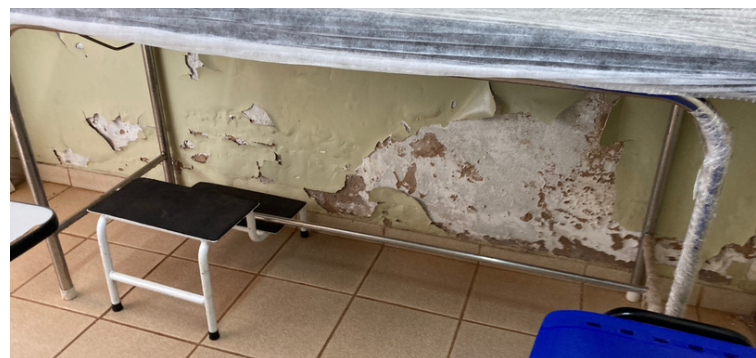
Foto 8 Infiltração na parede do consultório médico.
