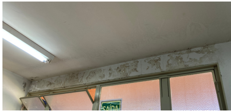
Foto 10 Infiltração na parede da recepção.
