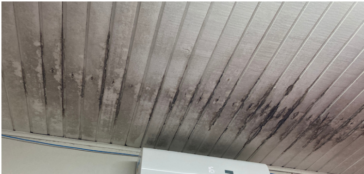
Foto 5 Infiltração no teto da sala da gerência.
