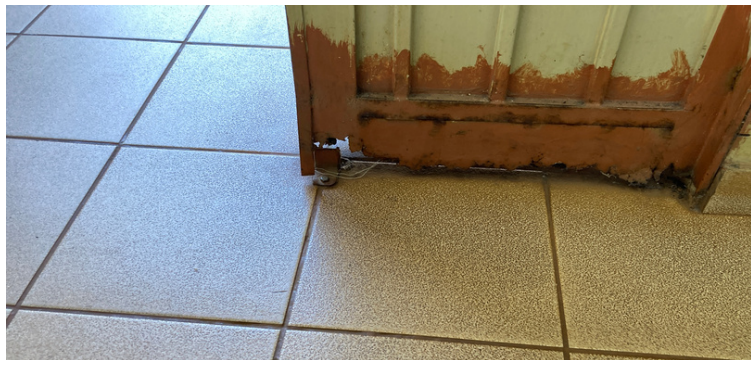
Foto 9 Porta de entrada principal enferrujada.
