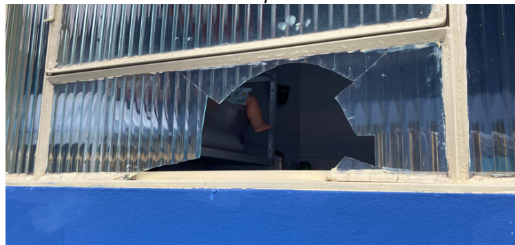
Foto 14 Janela com vidro quebrado
