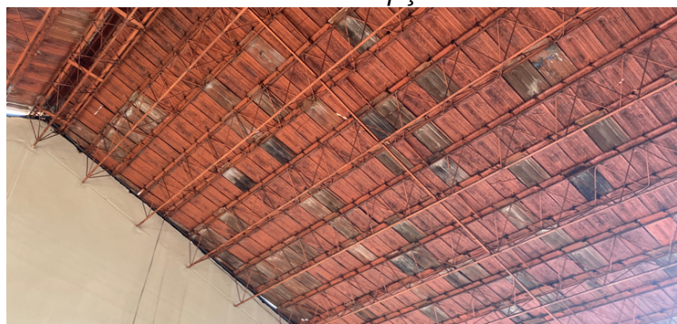
Foto 4 Telhado com goteira
