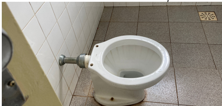
Foto 13 Vaso sanitário sem assento e tampa
