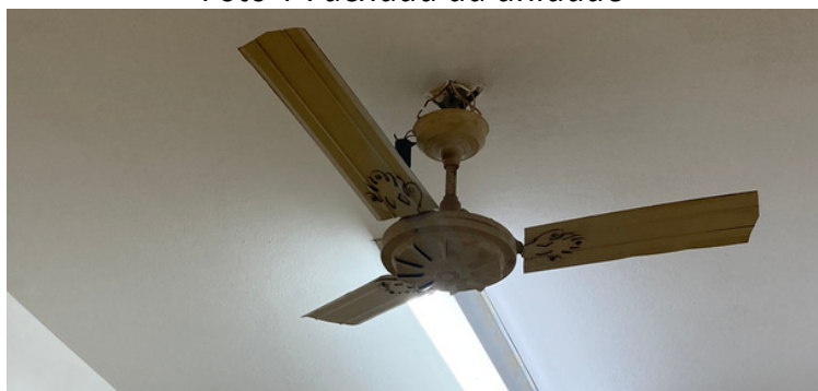
Foto 3 Parte elétrica exposta
