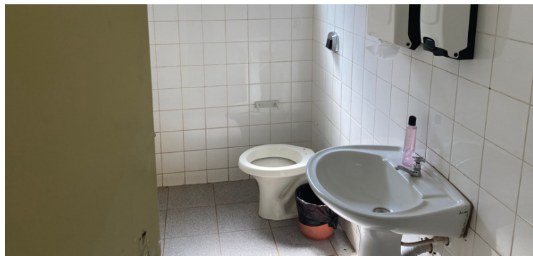
Foto 12 Falta de tampa no vaso sanitário
