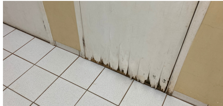
Foto 6 Porta do consultório danificada.
