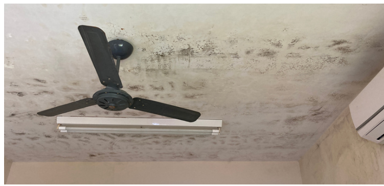
Foto 2 Infiltração no teto da sala de vacina.
