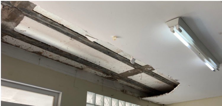
Foto 5 Forro da recepção danificado causado pelas infiltrações.
