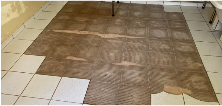
Foto 3 Piso da sala de vacina danificado causado pela infiltração do telhado.
