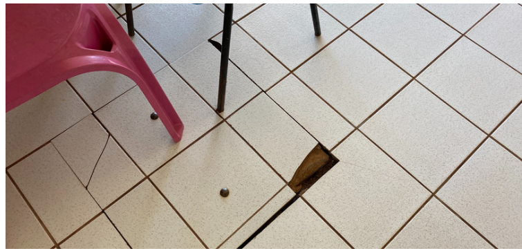
Foto 10 Piso da recepção quebrado.
