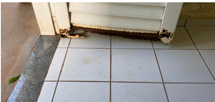
Foto 7 Porta da sala de curativos corroída por ferrugem.
