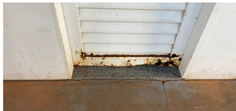
Foto 8 Porta da sala de vacinas enferrujada.
