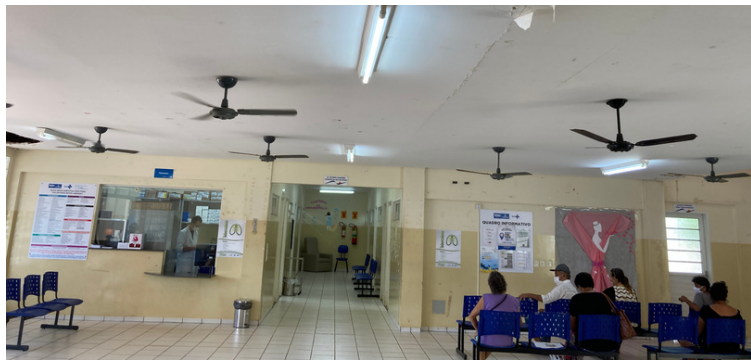
Foto 9 Ventiladores da recepção estragados, prejudicando a climatização do ambiente.
