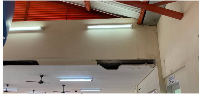
Foto 4 Forro de gesso caindo próximo ao corredor que liga a recepção aos consultórios.
