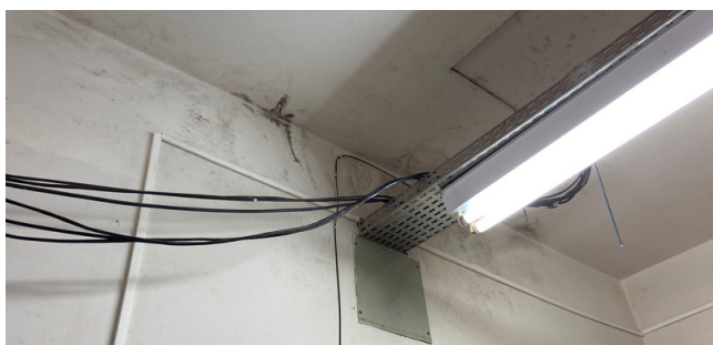
Foto 5 - Infiltrações encontradas em locais pontuais da unidade
