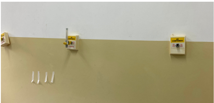
Foto 5 Aparelhos de nebulização sem funcionar por causa de infiltração no encanamento de oxigênio.
