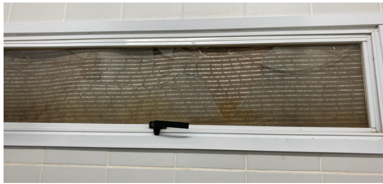
Foto 4 Janela com vidro quebrado no banheiro masculino.
