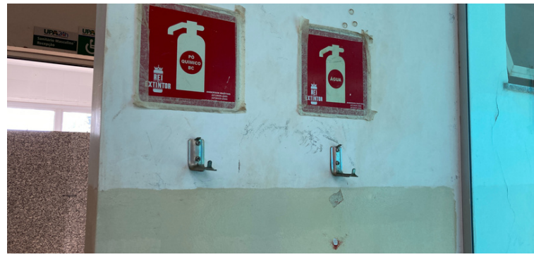
Foto 10 Falta de extintor de incêndio na recepção.
