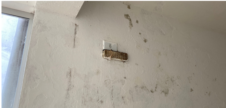
Foto 6 Infiltração na parede do corredor.
