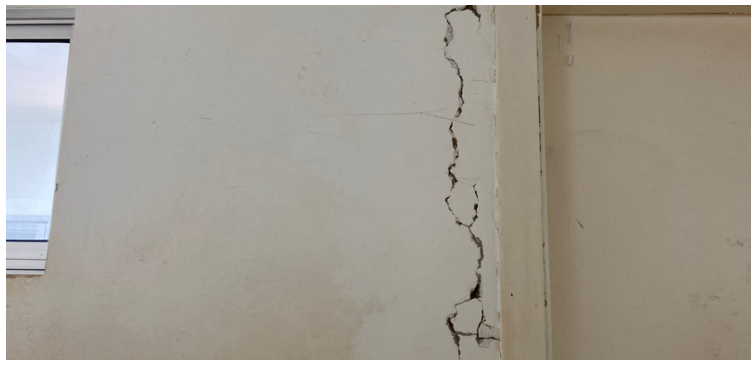
Foto 9 Rachadura próximo a porta de um dos consultórios.
