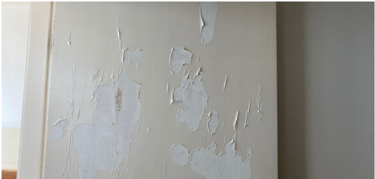
Foto 13 Porta em péssimo estado de conservação.
