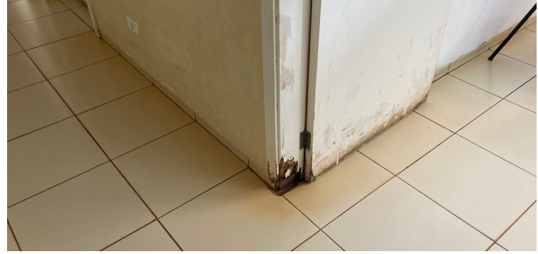
Foto 12 Batente da porta do consultório danificado.
