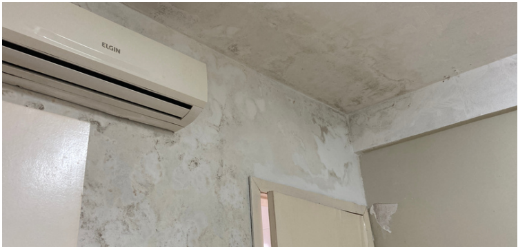
Foto 5 Infiltração na parede e teto em uma das salas.
