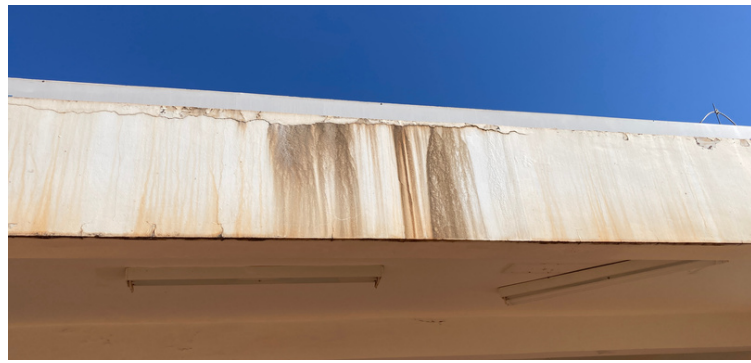
Foto 2 Infiltração na laje da unidade.
