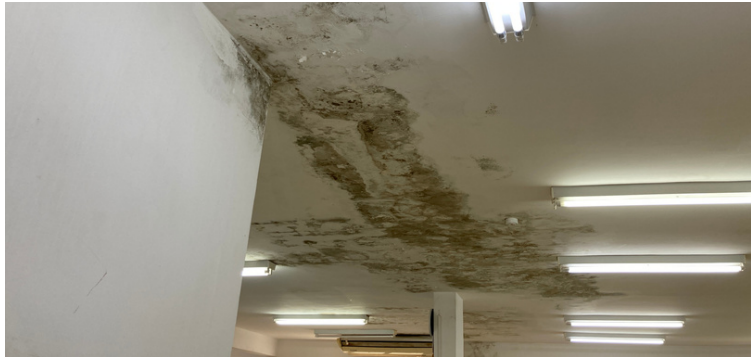
Foto 4 Infiltração com a presença de mofo na sala de observação.
