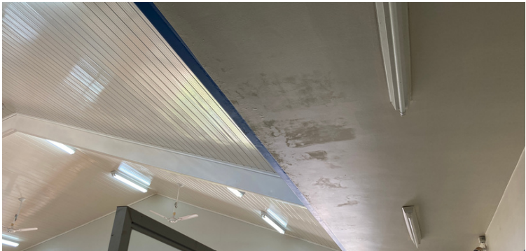
Foto 5 Infiltração no corredor da unidade de saúde
