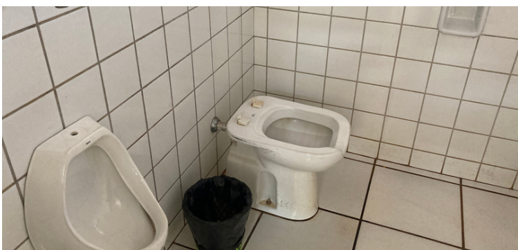
Foto 12 Vaso sanitário do banheiro masculino sem tampa e assento.
