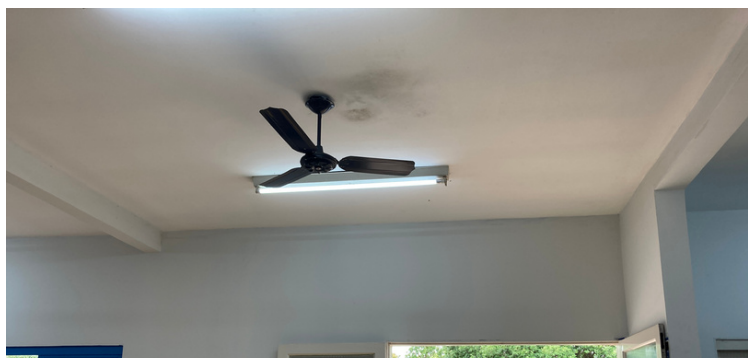
Foto 7 - Ventiladores inoperantes devido à falta de manutenção
