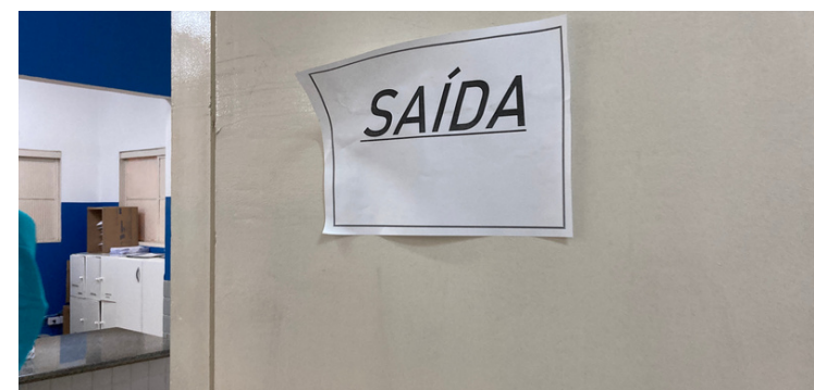
Foto 9 - Identificação da saída de emergência irregular
