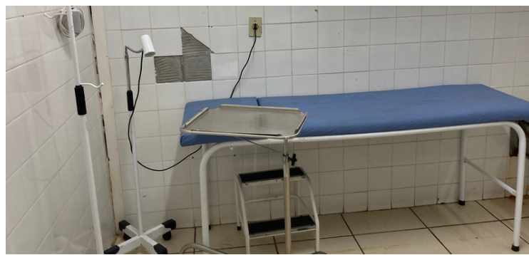
Foto 4 - Azulejos quebrados em um dos consultórios
