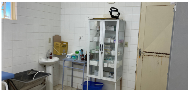
Foto 3 - Porta da sala de curativos repleta de ferrugem
