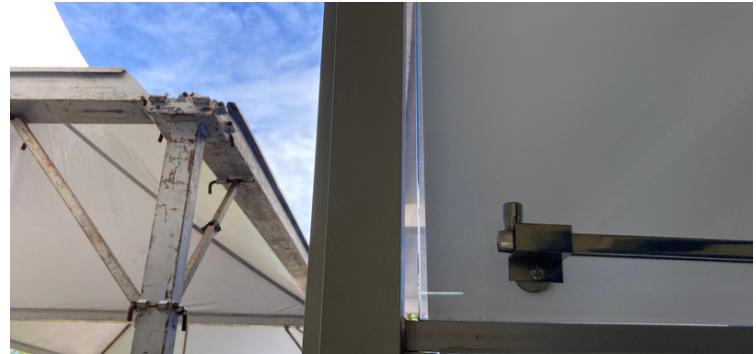
Foto 4 Vidro da janela desalinhado
