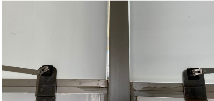
Foto 3 Vidro da janela desalinhado
