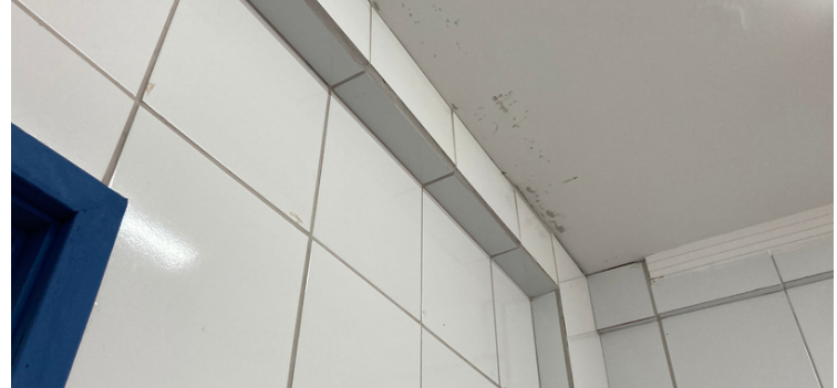
Foto 6 Falta de acabamento
