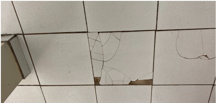
Foto 5 Piso na recepção quebrado.
