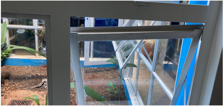
Foto 3 Janela no corredor danificada.
