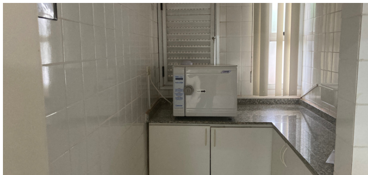
Foto 15 Autoclave estragada por falta de manutenção.
