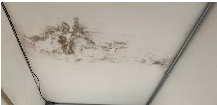
Foto 6 Infiltração no teto próximo a sala da gerência.
