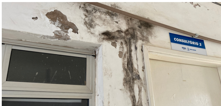
Foto 2 Infiltração com presença de mofo na parede do corredor.
