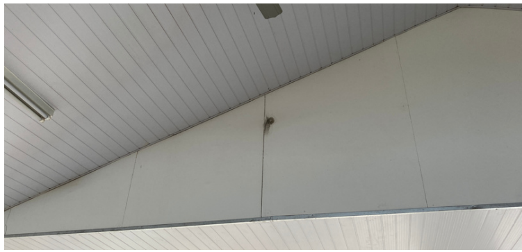
Foto 9 Rachaduras na estrutura da recepção.
