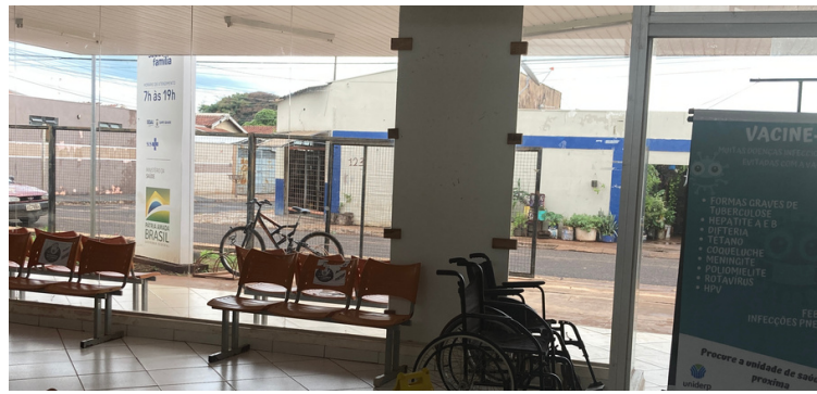
Foto 10 Tapume substituindo vidraça na recepção.
