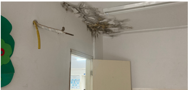
Foto 13 Infiltração próximo a porta do auditório.
