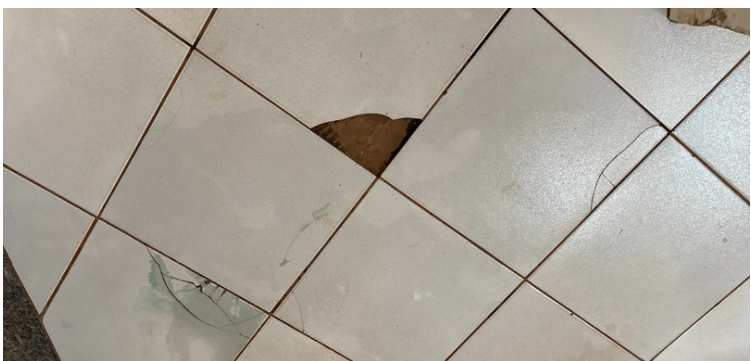
Foto 5 Piso quebrado no corredor de acesso aos consultórios.
