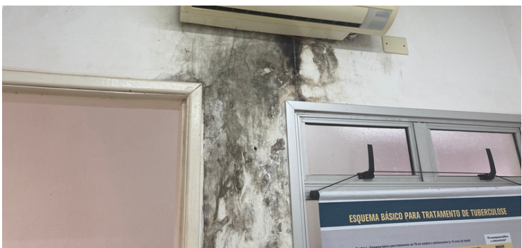
Foto 7 Infiltração grave na parede do consultório 3.
