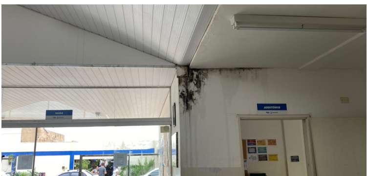
Foto 3 Infiltração com mofo na recepção ao lado do auditório.
