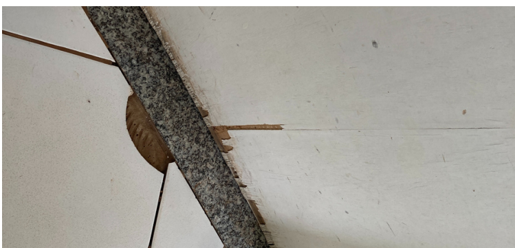
Foto 4 Piso quebrado próximo a porta do consultório 2.
