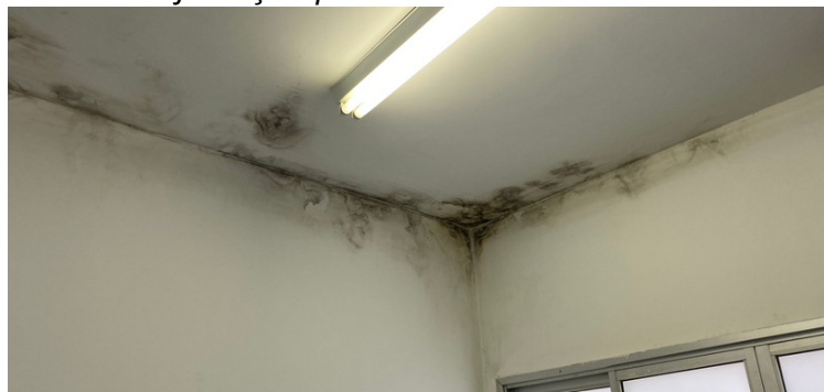
Foto 4 Infiltração no auditório
