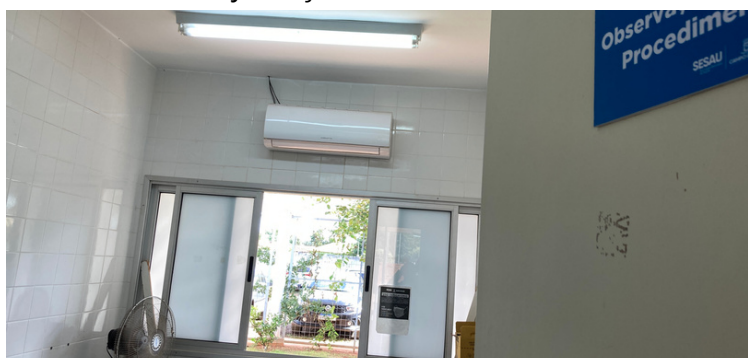
Foto 7 Ar-condicionado estragado na sala de observação
