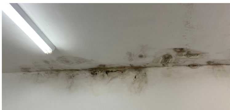
Foto 5 Infiltração no teto do auditório
