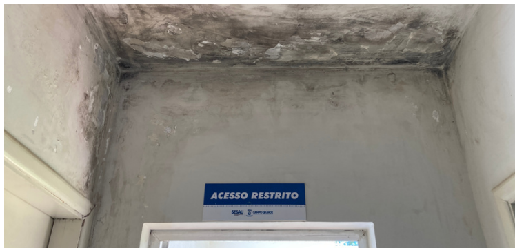
Foto 2 Infiltração próximo ao consultório médico
