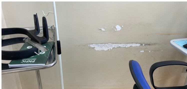
Foto 3 Parede do consultório descascando
