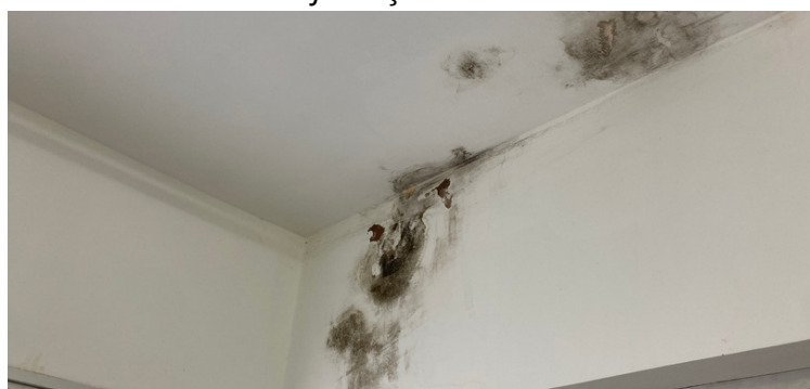
Foto 6 Infiltração na parede do auditório
