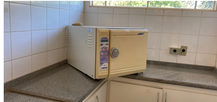
Foto 6 - Autoclave necessitando de manutenção
