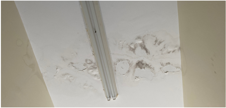
Foto 3 - Teto da unidade repleto de mofo
