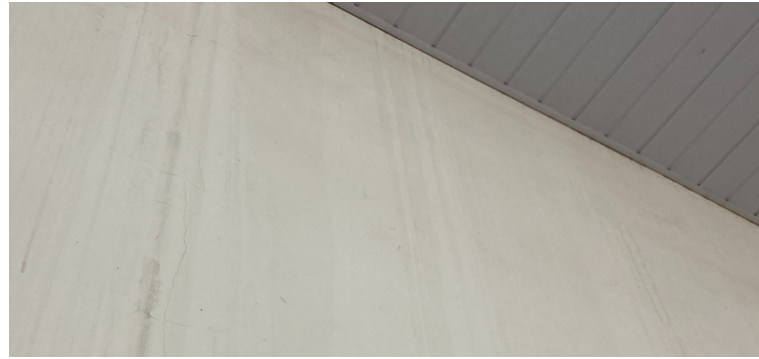
Foto 4 - Acúmulo de água no forro resulta em vazamento nas paredes da repartição
