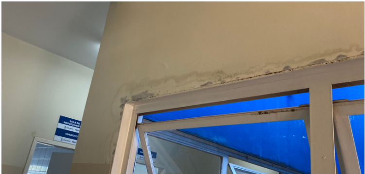
Foto 5 - Esquadrias avariadas devido à infiltrações
