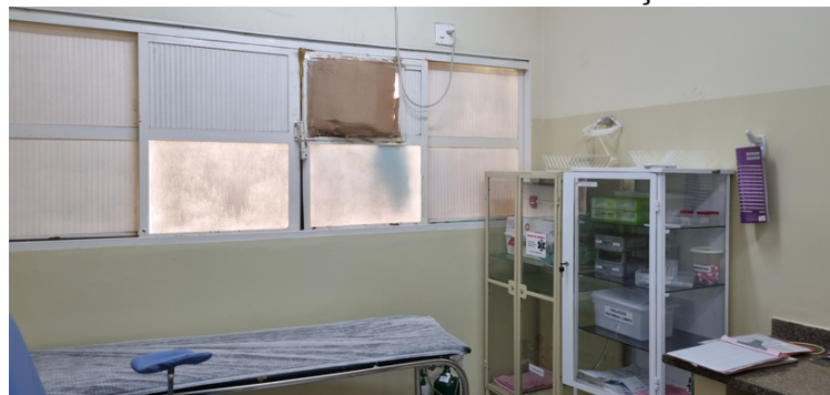
Foto 14 Porta sem pintura
