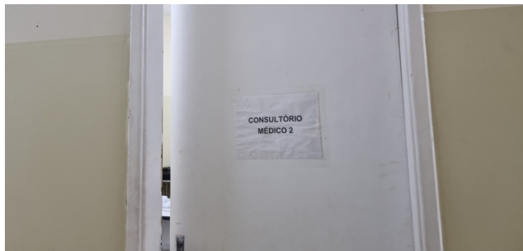
Foto 12 Porta com ausência de maçaneta
