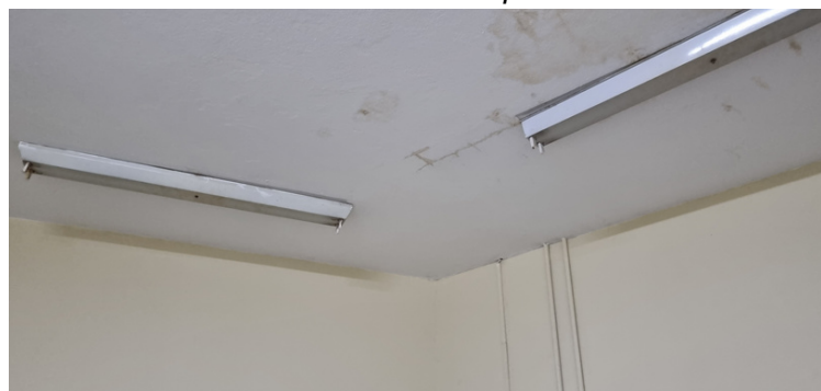
Foto 16 Consultório com infiltração
