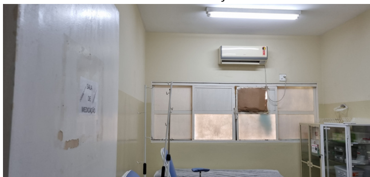
Foto 15 Janela sem vidro
