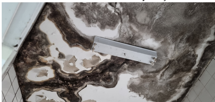
Foto 5 Sala de ginecologia com mofo e infiltração
