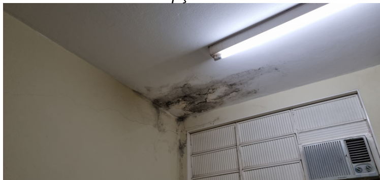
Foto 3 Consultório com infiltração
