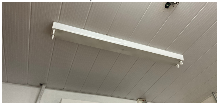
Foto 4 Falta de luminária
