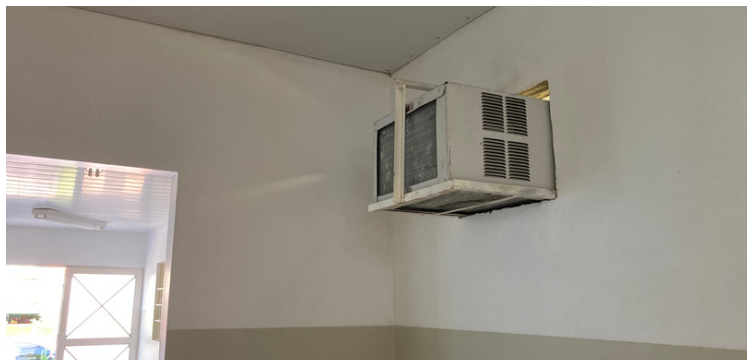
Foto 11 Ar-condicionado instalado incorretamente
