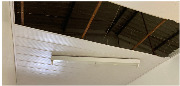
Foto 12 Teto sem forro
