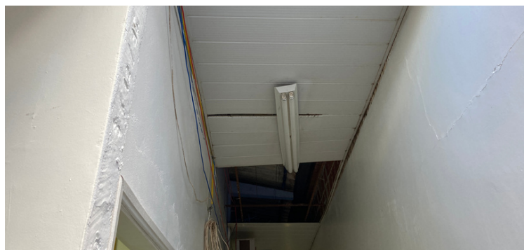
Foto 6 Teto sem forro
