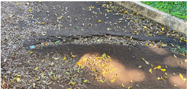
Foto 3 - Pista de caminhada com rachaduras, causando risco de queda para a população.
