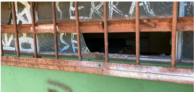
Foto 5 - Centro de apoio encontra-se abandonado e degradado.
