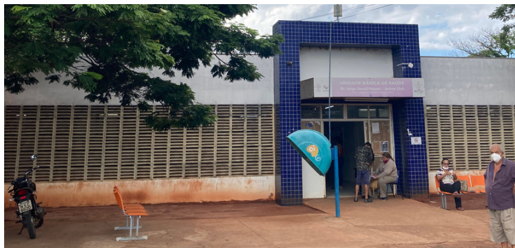
Foto 1 - Fachada da UBS necessitando ser revitalizada
