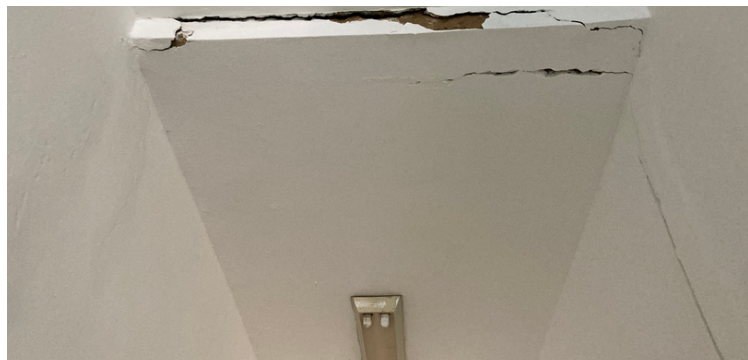
Foto 2 - Rachaduras nas dependências da UBS
