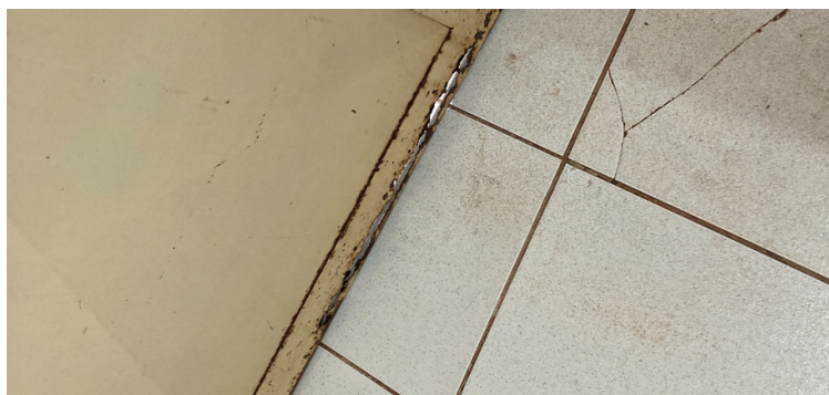
Foto 5 - Rachaduras nos pisos da unidade
