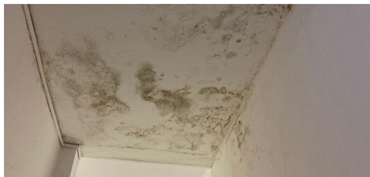
Foto 8 - Teto do corredor lateral à farmácia repleto de mofo
