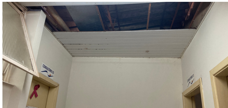
Foto 4 - Parte do forro da repartição comprometido
