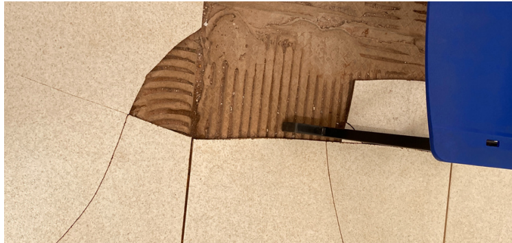
Foto 3 - Pisos trincados e quebrados, deixando o contrapiso à mostra
