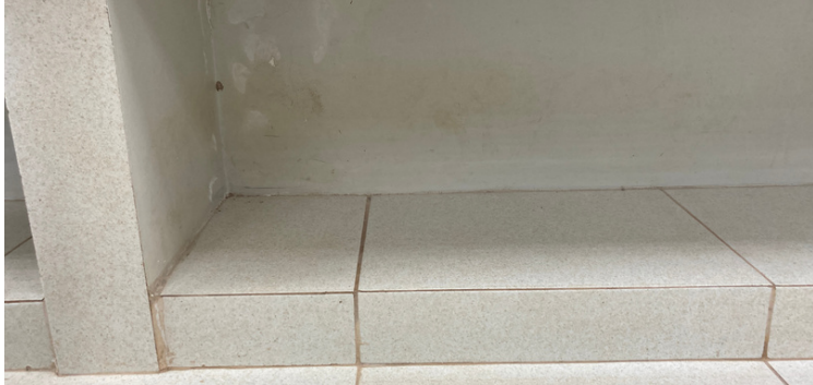
Foto 5 - Pontos de infiltração
