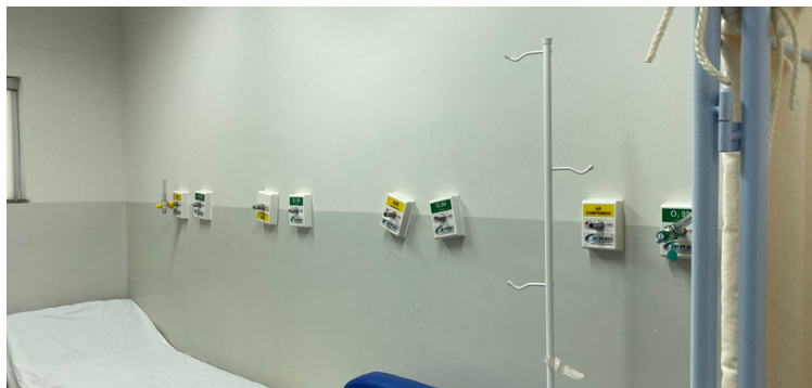
Foto 11 - Tubulação de oxigênio instalada
