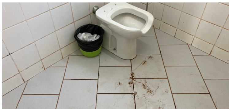
Foto 6 - Banheiro inadequado e extremamente sujo
