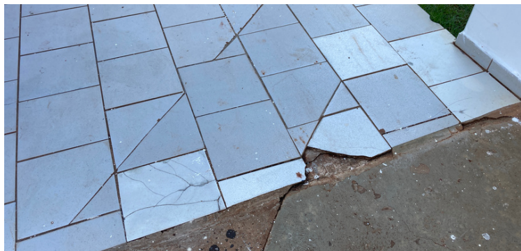
Foto 2 - Pisos trincados e quebrados na entrada da unidade
