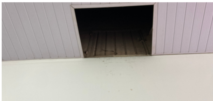
Foto 5 - Alçapão indevidamente aberto
