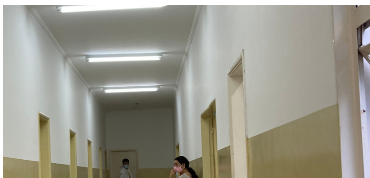
Foto 10 - Fiação elétrica aparente
