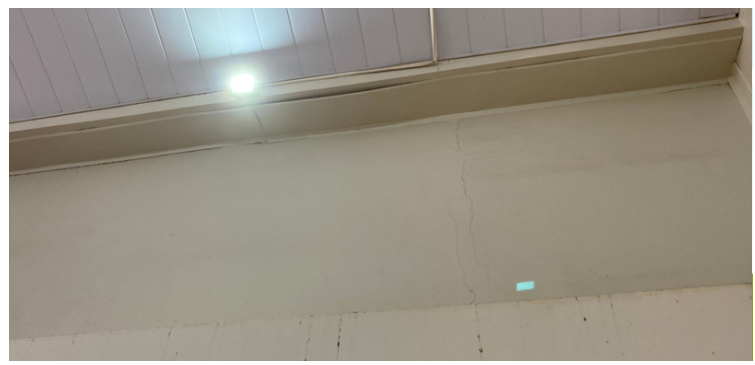
Foto 2- Teto da unidade quebrado e constante de rachadura
