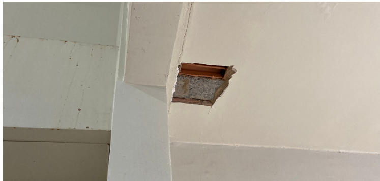
Foto 3 - Forro da recepção avariado devido à infiltração
