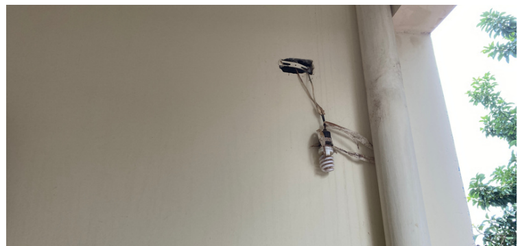
Foto 6 - Iluminação da área externa sem a devida instalação
