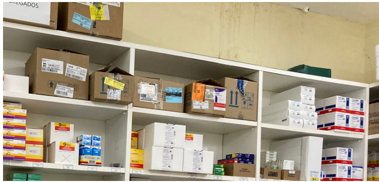
Foto 3 - Infiltração na sala da farmácia com risco de danos aos medicamentos.
