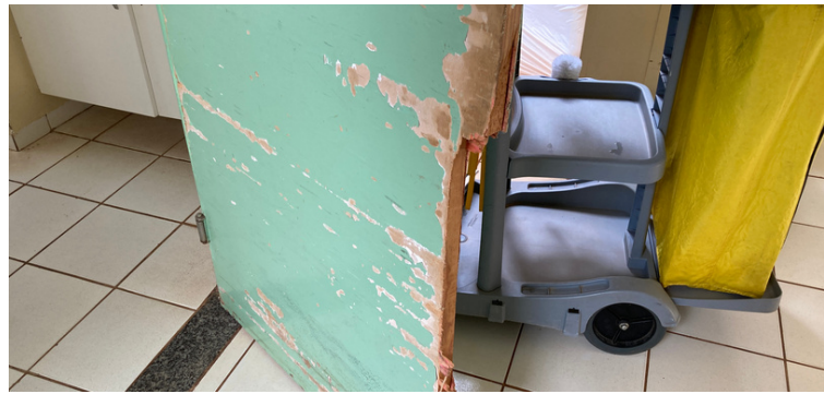
Foto 4 - Portas da unidade, em sua maioria, danificadas.
