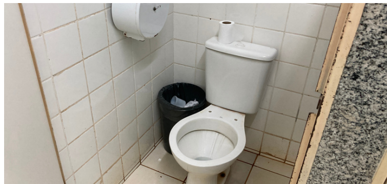
Foto 6 - Banheiros sem a devida manutenção e higienização.
