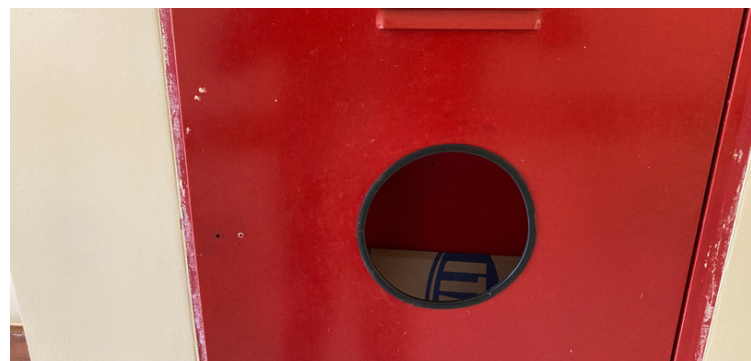
Foto 7 - Mangueira de incêndio furtada.
