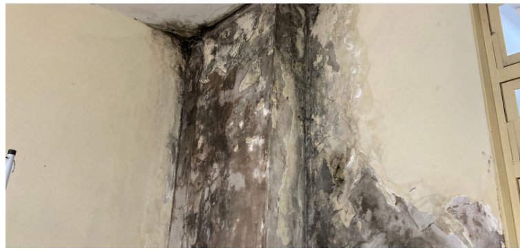
Foto 2 - Parede de um dos consultórios tomada pelo mofo, em decorrência da infiltração.
