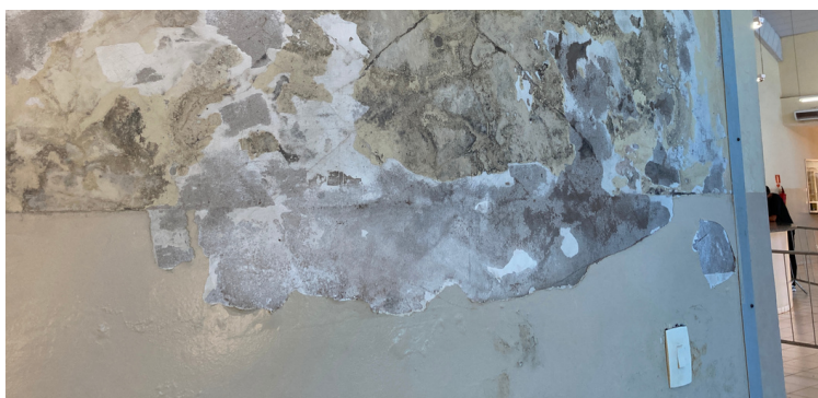
Foto 12 - Mofo alastrado por toda a unidade.
