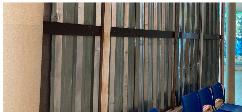
Foto 8- Tapumes desempenhando a função de vidros quebrados devido à queda de árvore.
