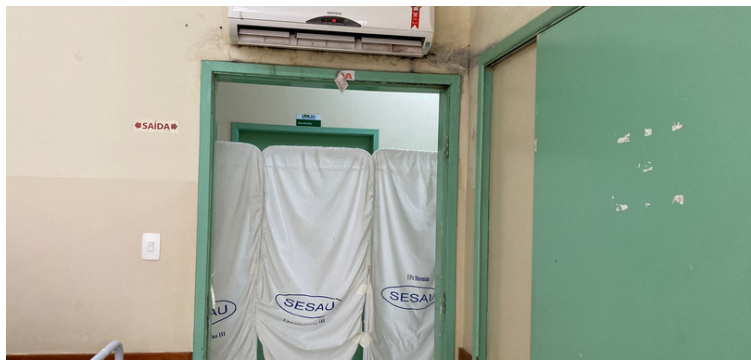
Foto 5 - Área verde da unidade sem a porta, devido à deprecação de usuário.
