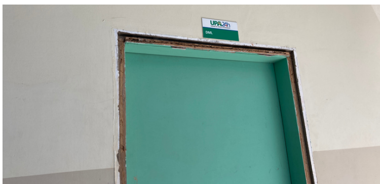
Foto 11 - Batente comprometido pela ferrugem.
