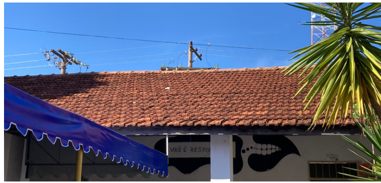
Foto 2 Telhado da unidade é muito antigo e não há telhas do mesmo padrão para troca.
