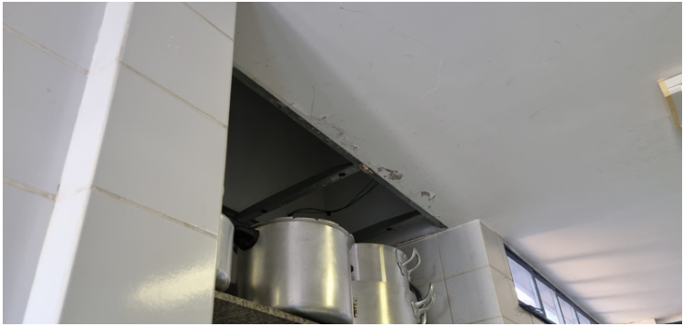
Foto 3 - Cozinha constantemente foco de infiltrações
