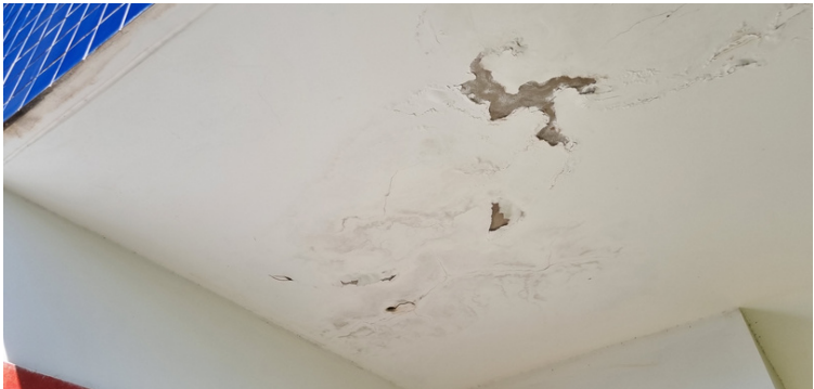
Foto 5 - Infiltrações constantes em locais pontuais da unidade
