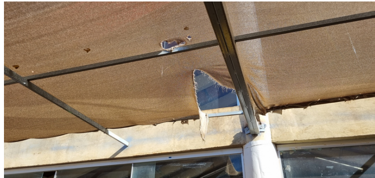
Foto 6 - Toldo instalado no pátio avariado
