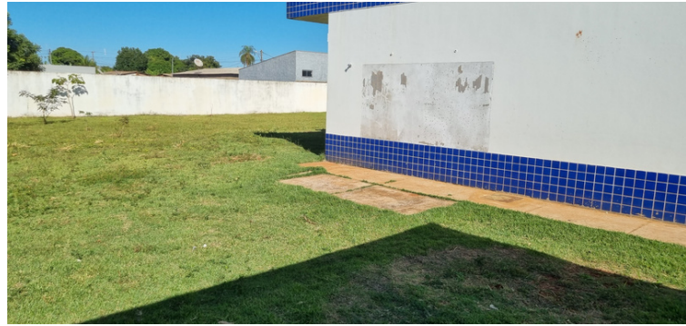
Foto 4 - Pintura externa requer revitalização
