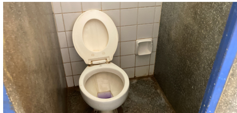
Foto 6 - Necessária manutenção dos banheiros.
