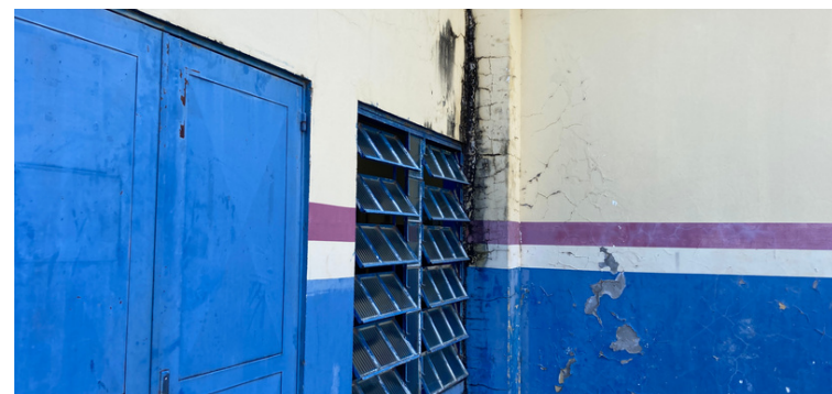
Foto 8 - Rachaduras e infiltrações em locais pontuais da unidade.
