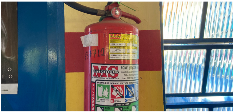
Foto 3 - Extintores com a data de validade vencida.
