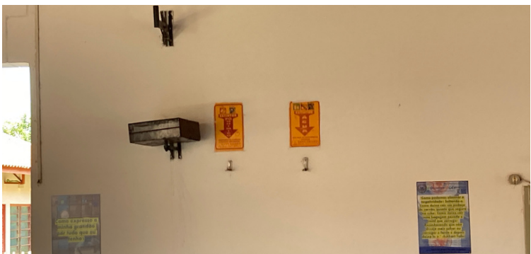
Foto 3 - Ausência de extintores por toda a extensão da unidade.
