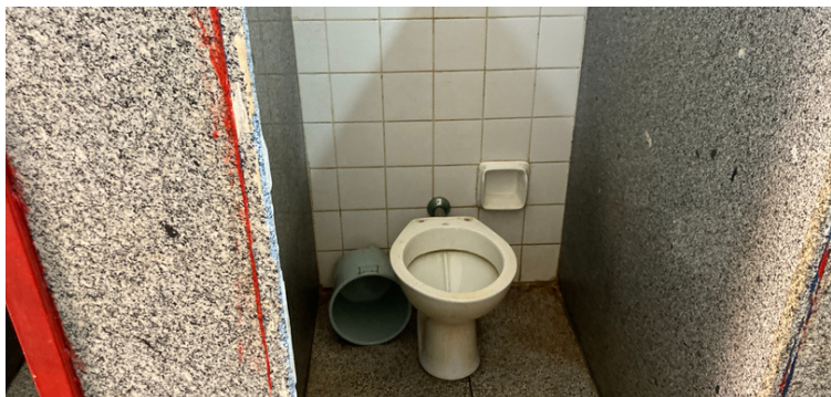
Foto 6 - Sanitários sem tampas sanitárias e hidras avariadas.
