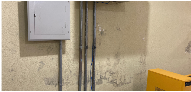
Foto 9 Infiltração na parede do laboratório de informática.
