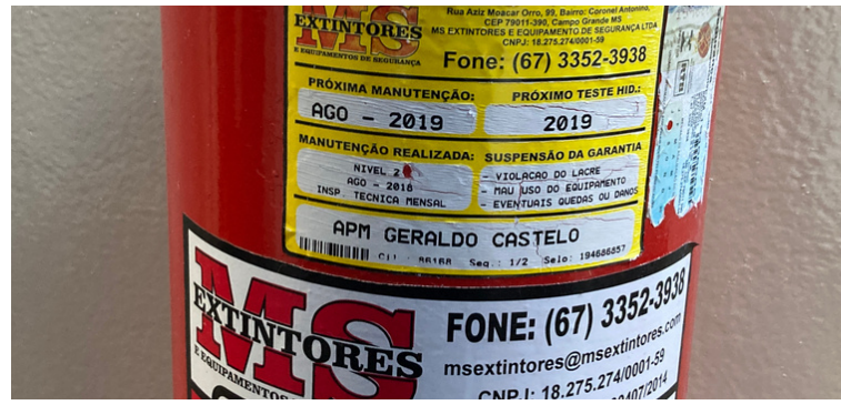
Foto 2 Extintor de incêndio fora do prazo de validade desde agosto de 2019.
