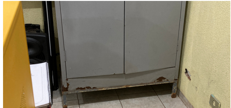
Foto 6 Armário quebrado e enferrujado.
