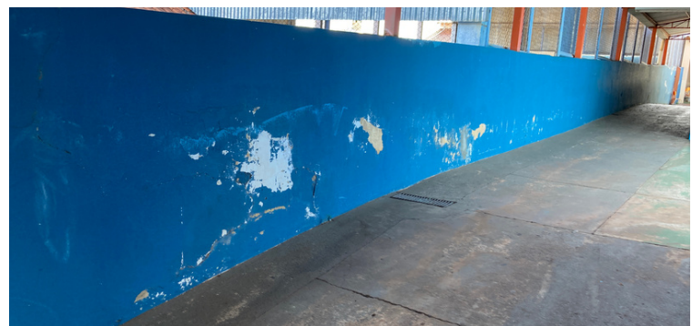
Foto 8 Muro da quadra de esportes com a pintura descascando.
