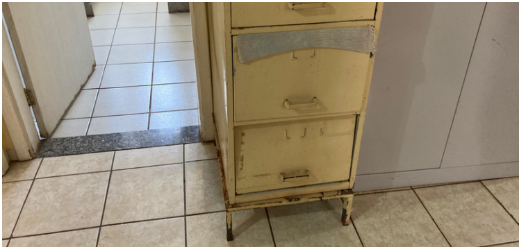
Foto 5 Armário antigo e danificado.
