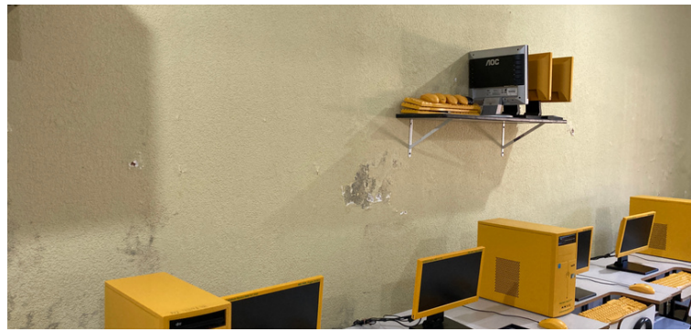
Foto 10 Infiltração danificando a pintura da parede no laboratório de informática.
