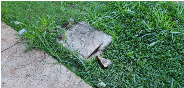
Foto 5 - Encanamento constantemente entupido, afetando toda a rede de esgoto da unidade
