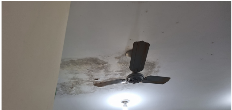
Foto 6 - Infiltrações constantes em locais pontuais da instituição
