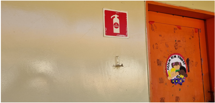
Foto 3 - Ausência de extintores por toda extensão da escola
