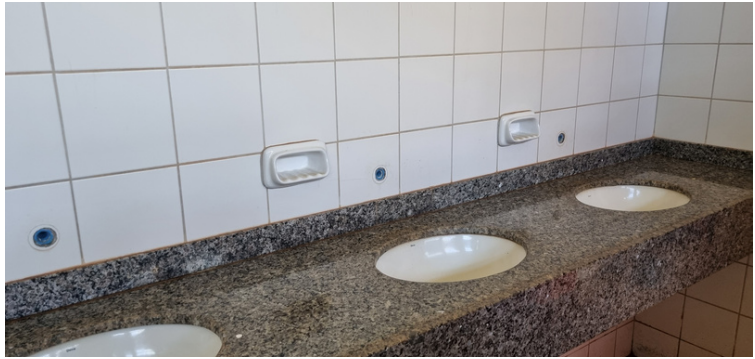
Foto 4 - Precisão de instalação de torneiras no banheiro feminino
