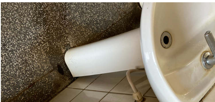
Foto 8 Vazamento na pia do banheiro.
