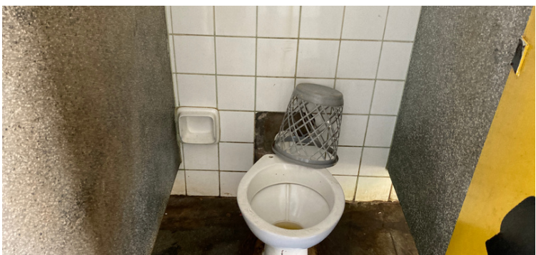
Foto 7 Vaso sanitário sem assento e tampa.
