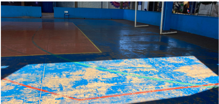
Foto 3 Pintura da quadra de esportes descascando.
