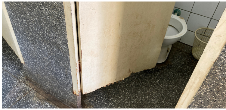
Foto 9 Portas danificadas no banheiro.
