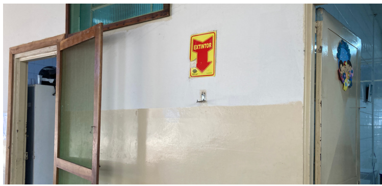
Foto 2 Falta de extintores de incêndio nos suportes.
