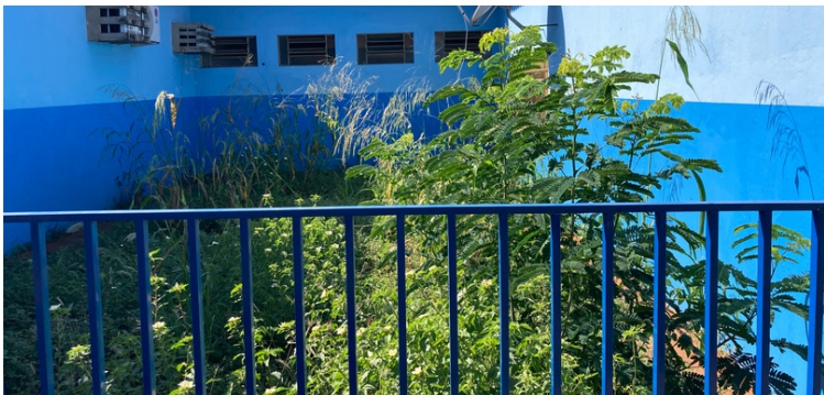
Foto 4 Área verde com necessidade de manutenção.
