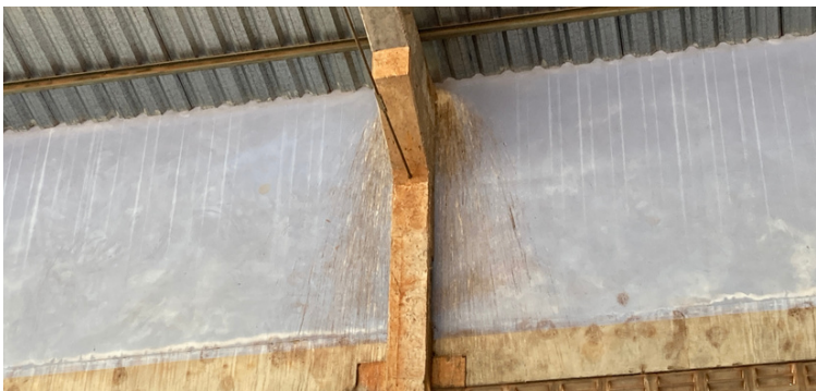
Foto 6 Presença de fezes de pombos na estrutura da quadra de esportes.
