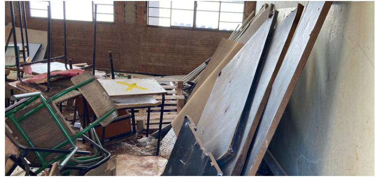
Foto 12 Interior da sala de aula onde a obra está paralisada.
