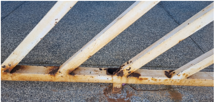
Foto 5 Grades corroídas por ferrugem.
