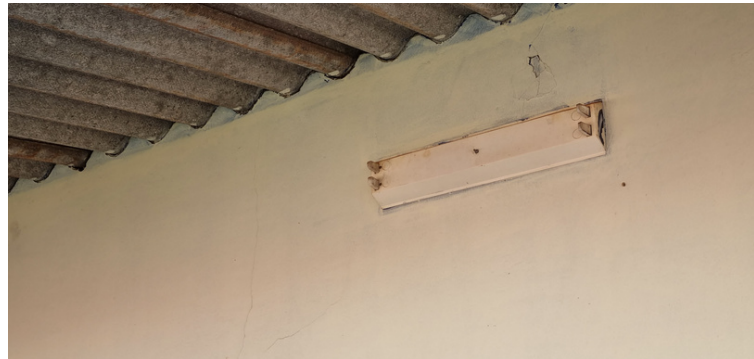
Foto 6 Falta de lâmpadas nas luminárias.
