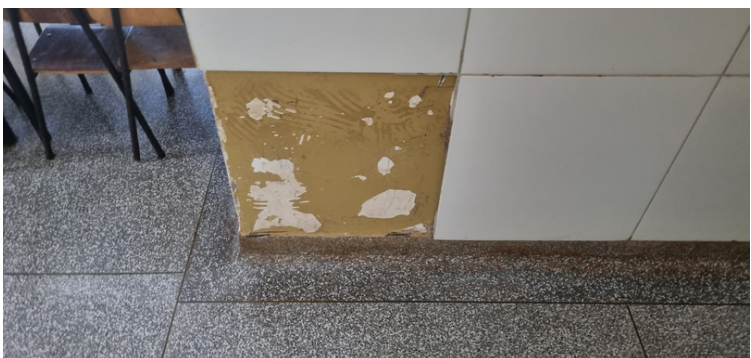
Foto 7 Azulejos quebrados no refeitório.
