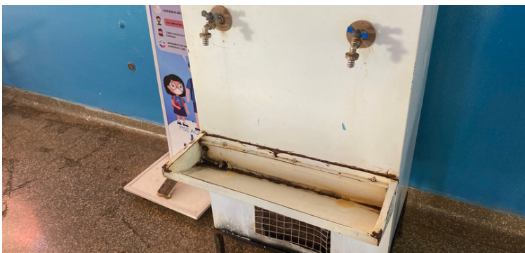
Foto 3 - Bebedouro oxidado totalmente insalubre.
