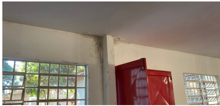
Foto 2 - Infiltrações em locais pontuais da unidade.
