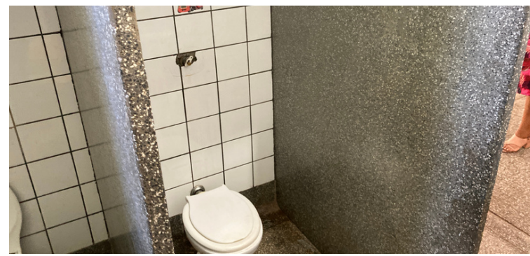
Foto 8 - Necessidade de manutenção dos banheiros.
