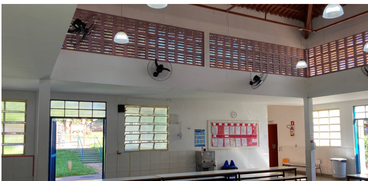
Foto 7 - Arquitetura do refeitório acarreta na entrada de água e sujeira.
