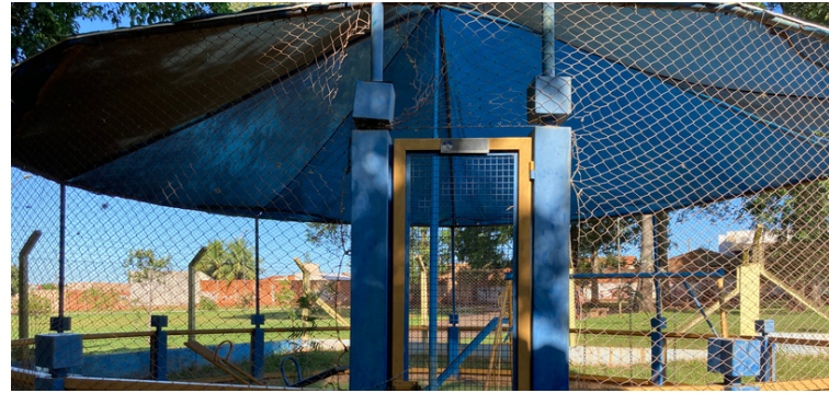
Foto 4 - Parquinho interditado necessitando de manutenção e reparos.
