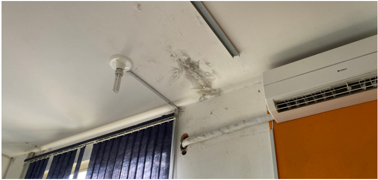
Foto 3 - Infiltrações encontradas em locais pontuais da unidade.
