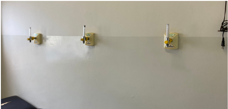
Foto 5 - Rede de oxigênio necessitando de manutenção.
