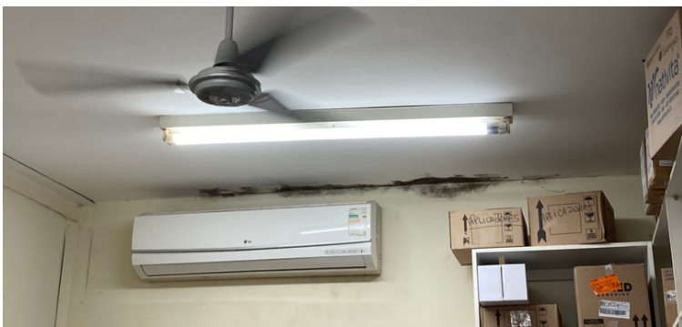
Foto 4 Infiltração na farmácia causada pelo ar-condicionado.
