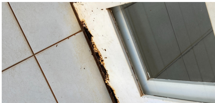
Foto 2 Porta da entrada principal da unidade corroída por ferrugem.
