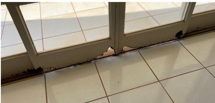
Foto 3 Porta dos fundos próximo a sala da gerência com presença de ferrugem.
