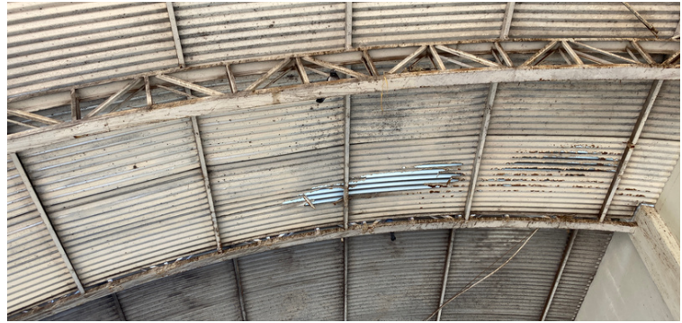
Foto 20 Estrutura da cobertura na área do SAMU corroída por ferrugem.
