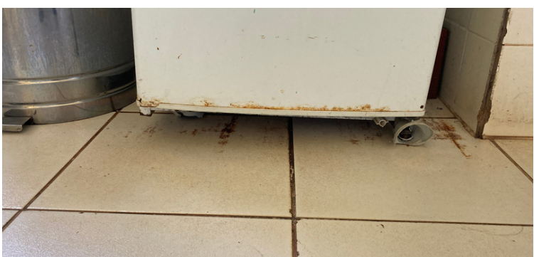
Foto 7 Geladeira da copa quebrada.
