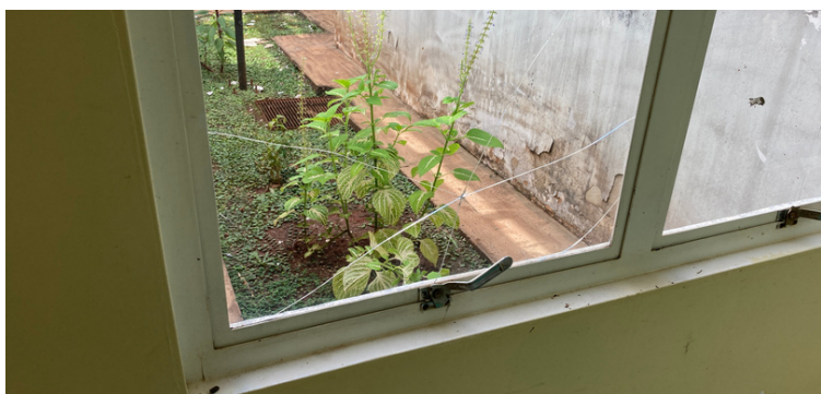
Foto 4 Janela do corredor com vidro quebrado.
