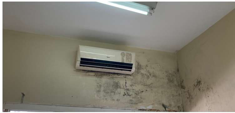
Foto 10 Ar-condicionado com vazamento, causando infiltração com mofo.
