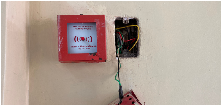
Foto 11 Fiação do sistema de prevenção de incêndio exposta.
