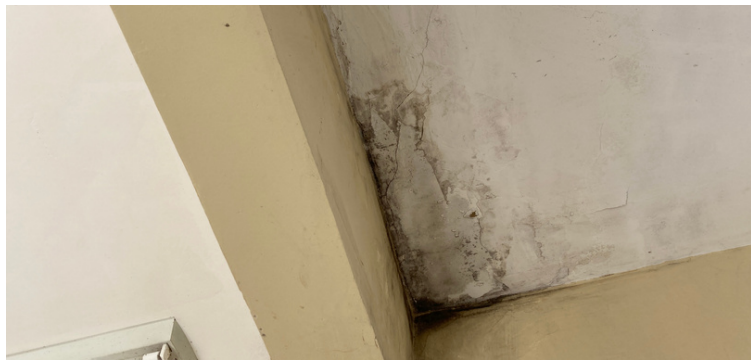
Foto 9 Infiltração no teto próximo a recepção.
