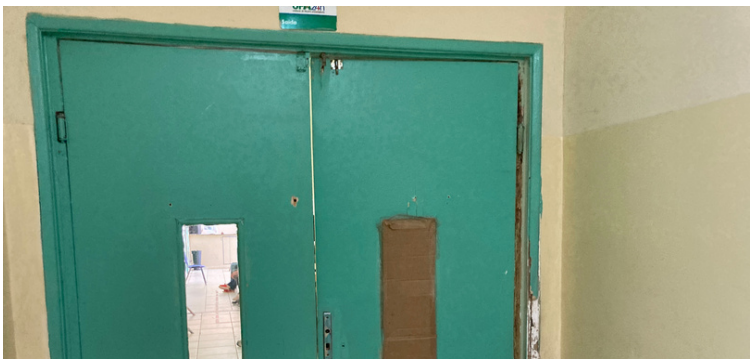
Foto 13 Porta de entrada da emergência deteriorada.
