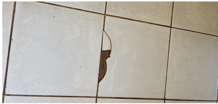
Foto 18 Piso quebrado nos corredores.
