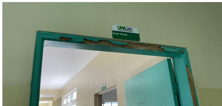
Foto 2 Batente da porta de entrada da área verde danificado e com a presença de cupins.
