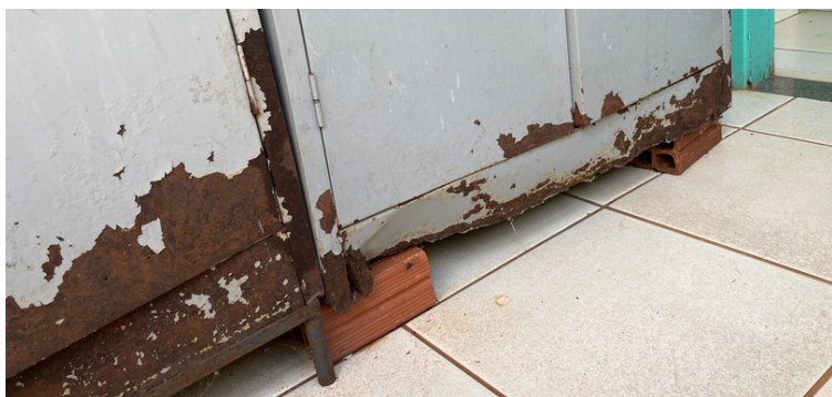
Foto 6 Armários enferrujados e sustentados por tijolos.
