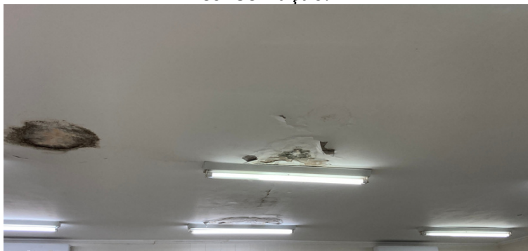
Foto 16 Infiltração com mofo no teto da internação infantil.
