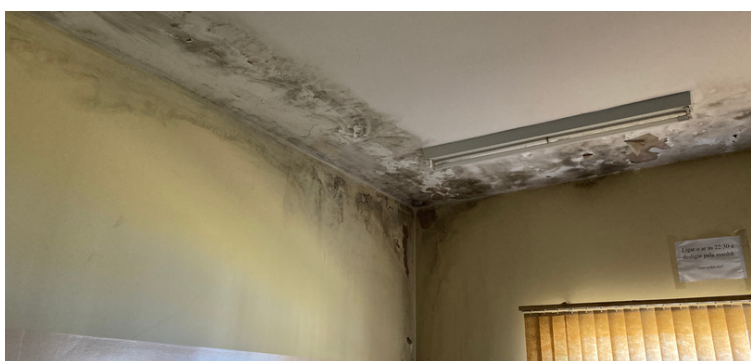
Foto 8 Infiltração no teto do dormitório utilizado pelos servidores.
