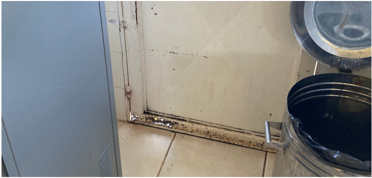
Foto 19 Porta da copa corroída por ferrugem.
