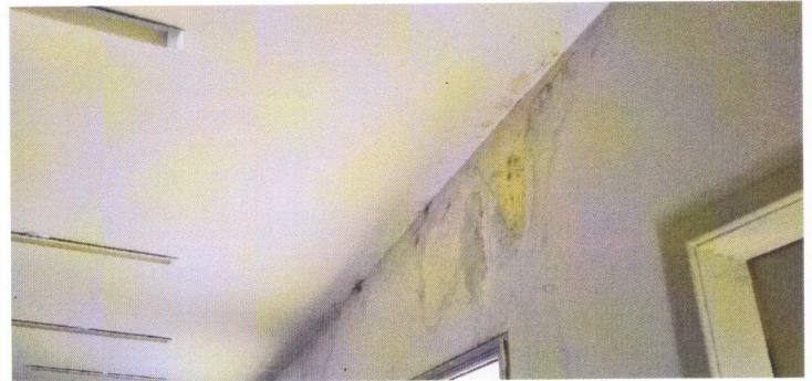
Foto 2 Infiltração no teto e parede causada por entupimento nas calhas.
