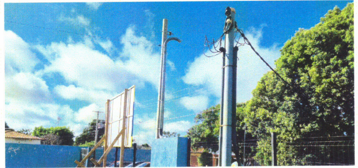
Foto 4 Padrão de energia antigo, necessária a troca para o novo que está instalado ao lado.
