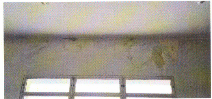
Foto 6 Infiltração em uma das salas de atendimento.
