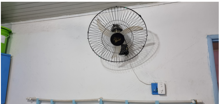
Foto 7 - Salas com ventiladores, os quais não fornecem a devida climatização.
