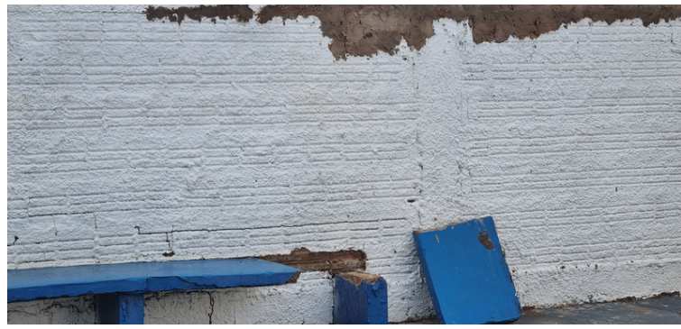
Foto 2 Banco quebrado e muro rebocado devido à queda de árvore ocorrida no local.
