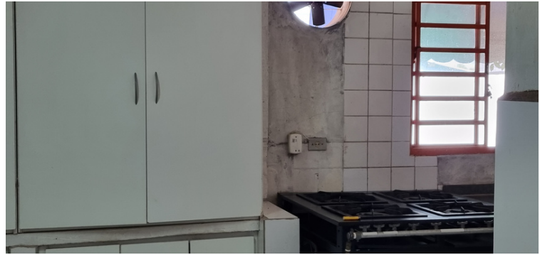
Foto 4 - Cozinha necessitando de considerável reforma e revitalização na pintura.
