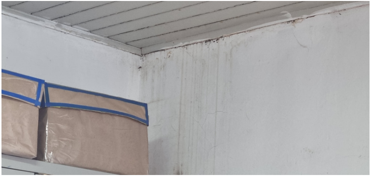
Foto 3 - Infiltração encontrada em locais pontuais da escola.
