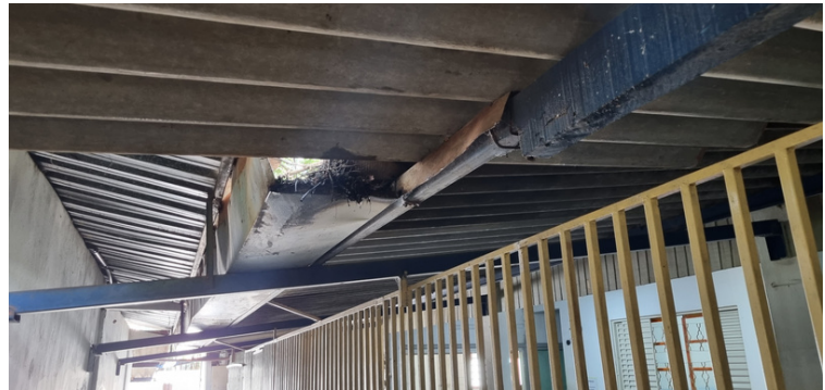
Foto 6 - Calha encontra-se constantemente entupida, bem como com caimento de água dentro da escola.
