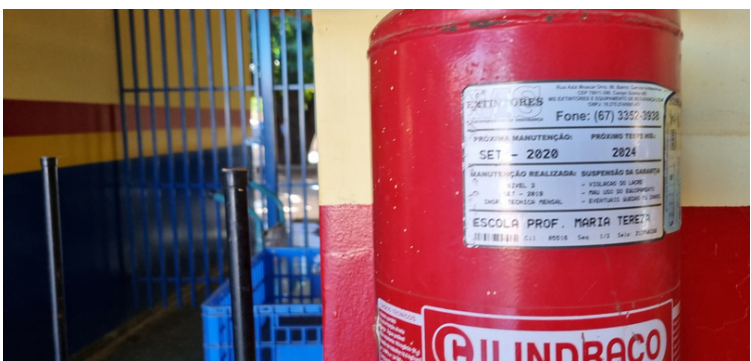
Foto 3 Extintor de incêndio vencido desde setembro de 2020.
