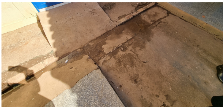
Foto 6 Rampa de acessibilidade não está uniformidade, dificultando o acesso de cadeirantes.
