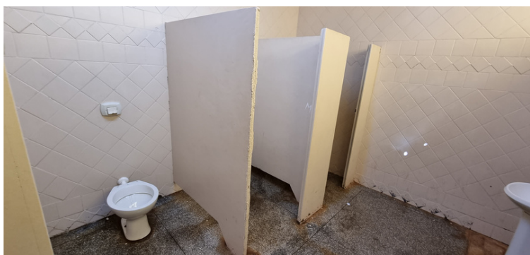
Foto 4 Falta de portas no banheiro, bem como falta de assento e tampa nos vasos sanitários.
