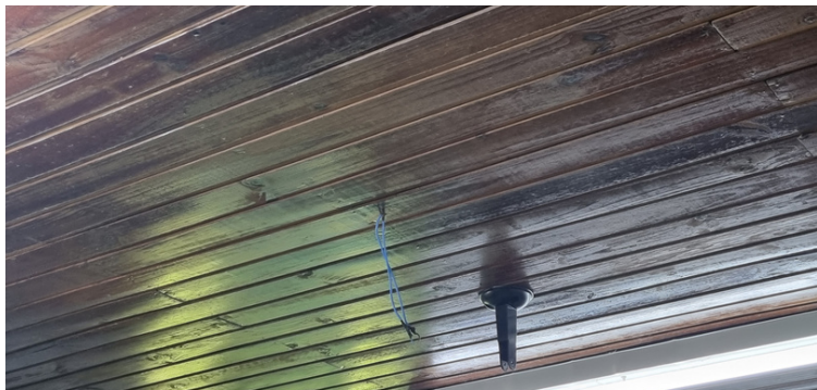
Foto 4 Ausência de ventilador e fiação exposta.
