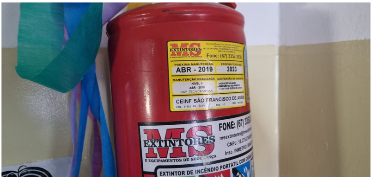
Foto 3 Extintores com a data de validade vencida.
