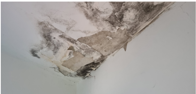
Foto 5 Mofo no teto da escola, consequência de infiltração.
