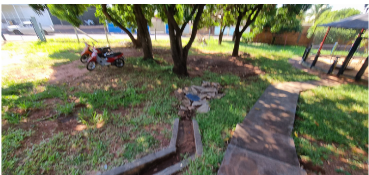
Foto 7 Necessidade de reestruturação do duto de drenagem de água pluvial.
